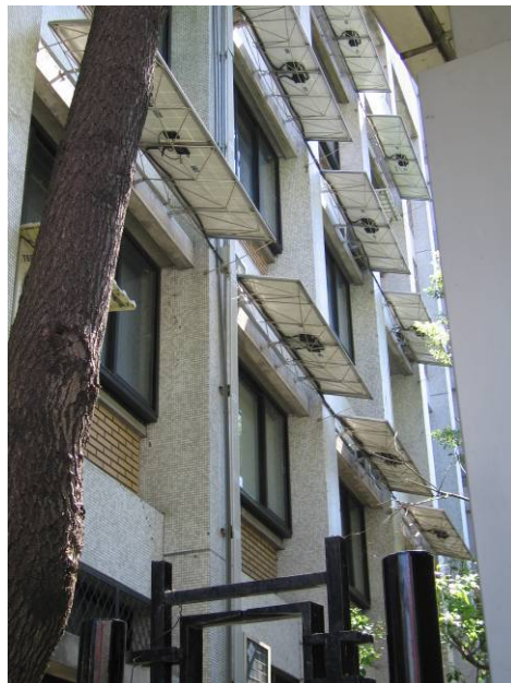
台灣—台北科技大學(陳文樹拍攝提供) 說明：傳統建築物採用電光板當水平遮陽板具有再生 能源及遮陽效果。
