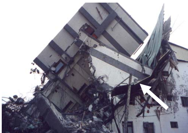
圖 1- 1 大里王朝大樓拆除中倒塌壓到鄰房
