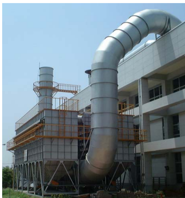
圖 2-2 廢氣處理系統
