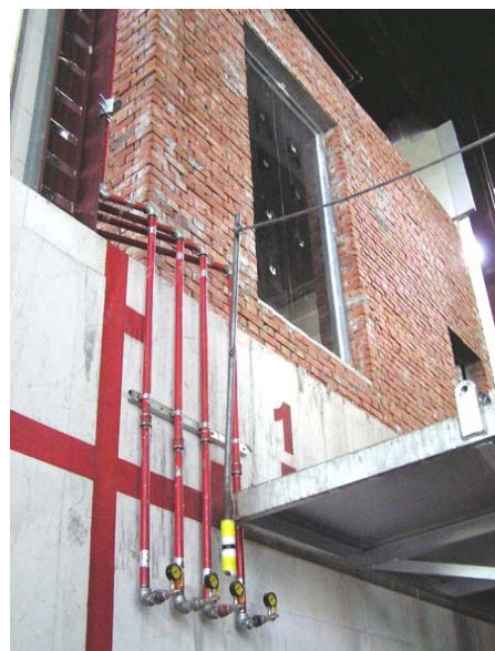
圖 3-6 撒水頭管路及壓力表
