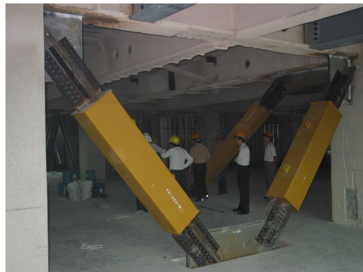
圖 2.7 台北縣政府政挫屈束制支撐 (資料來源：國家地震中心提供)
