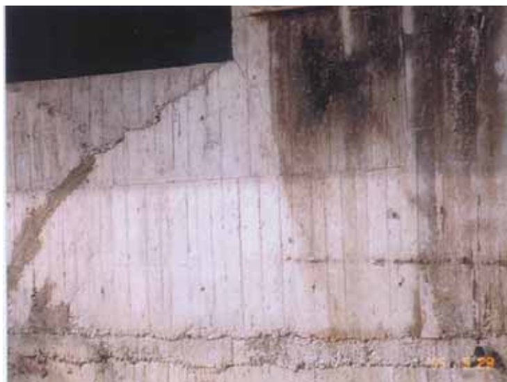
照片 2-5 興建未完成隻四樓公寓牆壁有龜裂情形 (照片來源：台灣省大地技師公會提供)
