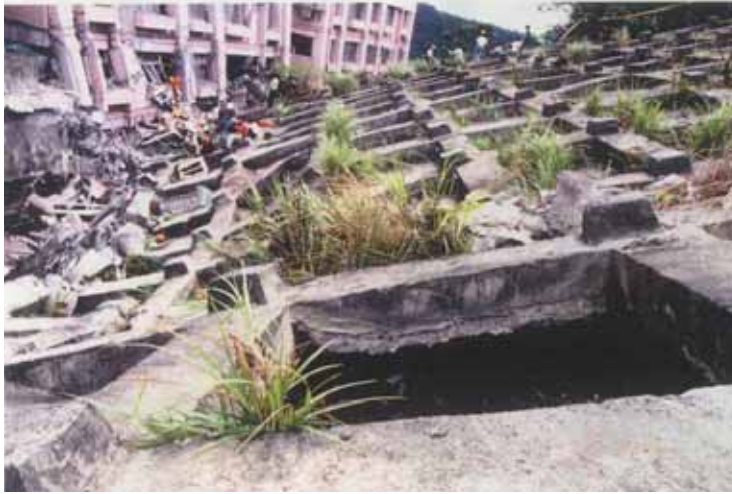
照片 2-21 坍塌區中央主裂面，岩體滑動， 格梁懸空之情形 (照片來源：李景亮技師提供)
