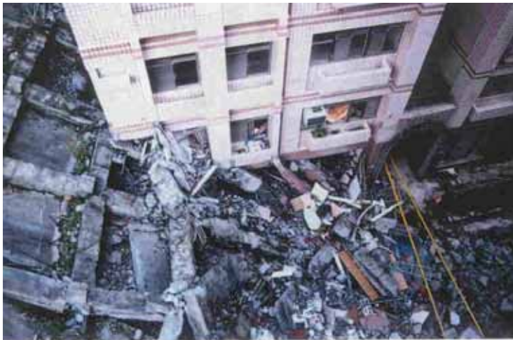
照片 2-15 第二區 74 號 1 樓損毀情形 (照片來源：李景亮技師提供)
