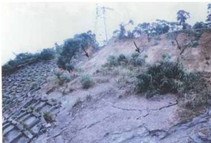
照片 2-27 坍塌區滑動面上有明顯之縱向張力裂縫 (照片來源：台灣省大地技師公會提供)
