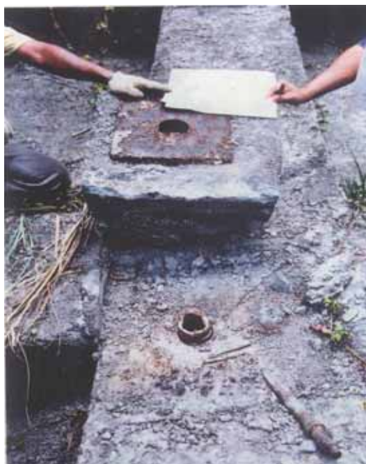
照片 2-24 坍塌區中 A 區之地錨鋼腱斷裂、錨座銹蝕情形 (照片來源：台灣省大地技師公會提供)
