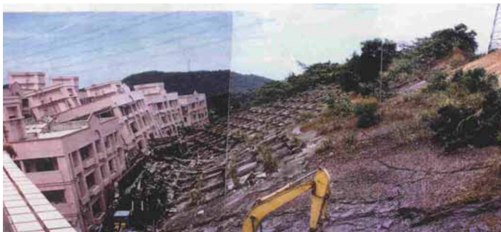
照片 2-12 北側邊坡西半部坍塌情形 (照片來源：台灣省大地技師公會提供)
