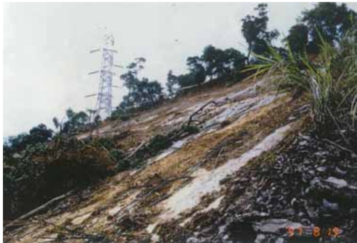
照片 2-26 坍塌區中 C 區之地錨錨頭全毀、鋼腱裸露於滑動面上 (照片來源：台灣省大地技師公會提供)
