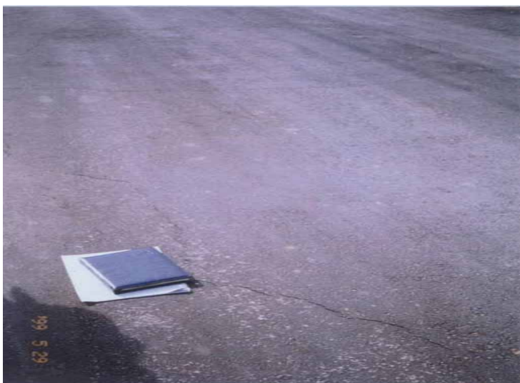
照片 2-7 社區道路路面有裂縫產生 (照片來源：台灣省大地技師公會提供)
