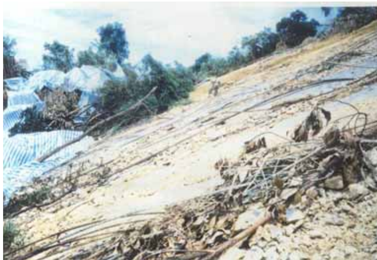
照片 2-30 坍塌區露出之最上層滑動面情形 (照片來源：台灣省大地技師公會提供)
