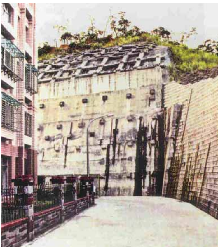
照片 2-13 坍塌前北側邊坡東隅情形；擋土牆有明顯出水之現象 (照片來源：台灣省大地技師公會提供)
