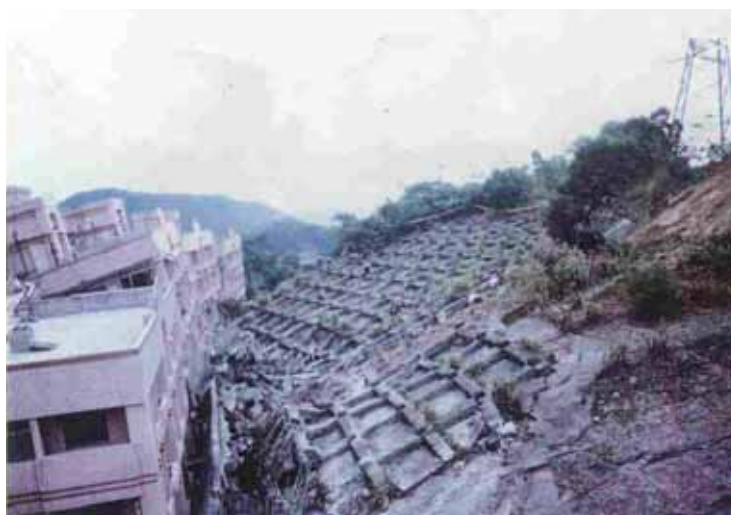
照片 2-17 第三區北側格梁地錨滑動破壞情形 (照片來源：李景亮技師提供)
