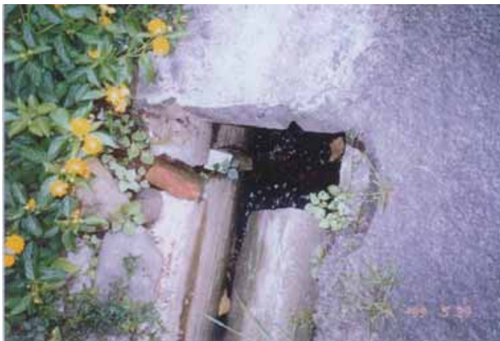
照片 2-6 局部排水溝龜裂情形 (照片來源：台灣省大地技師公會提供)
