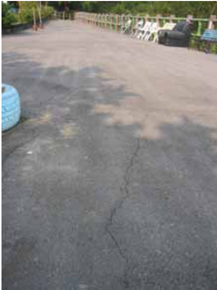
照片 5-7 填方區 AC 道路路面裂縫現況 (照片來源：本研究攝製)
