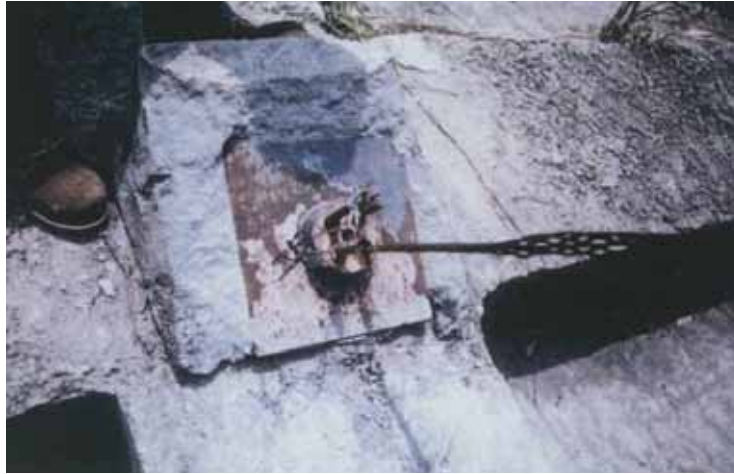
照片 2-25 坍塌區中 B 區之地錨鋼腱射出、露出錨頭外之情形 (照片來源：台灣省大地技師公會提供)
