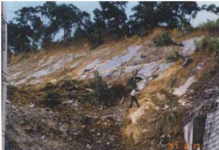
照片 2-22 坍塌區東側格梁完全下滑後之情形 (照片來源：李景亮技師提供)
