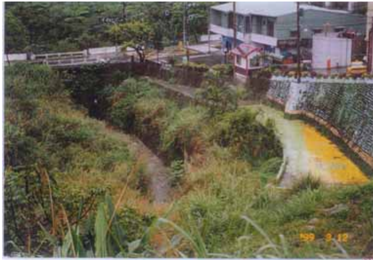
照片 2-8 坡趾處之河流直接衝擊坡趾部 該護坡已出現龜裂沉陷情形 (照片來源：台灣省大地技師公會提供)
