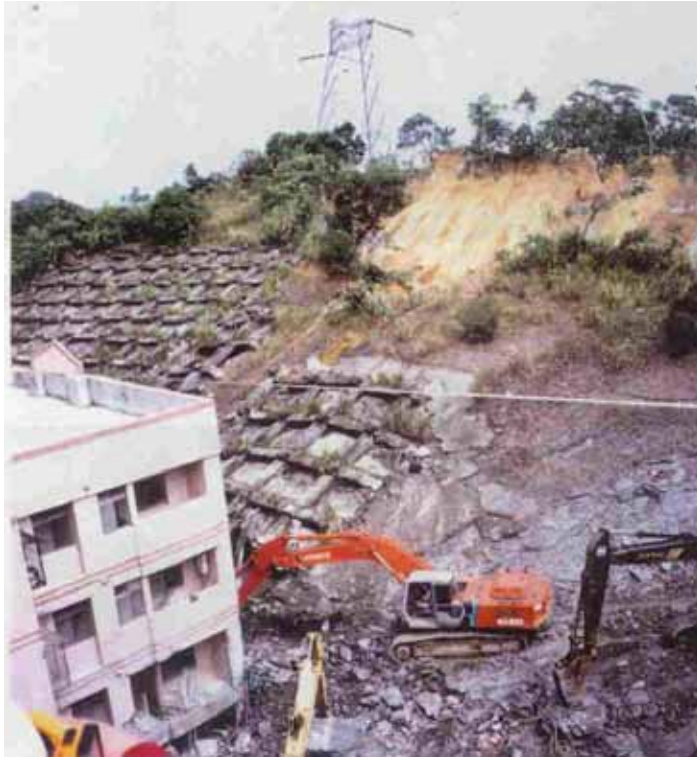
照片 2-14 北側邊坡西半部坍塌，導致第三區 205~235 號一、二樓梁柱斷裂情形 (照片來源：李景亮技師提供)
