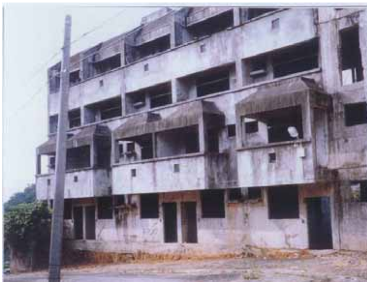
照片 2-4 興建未完成隻四樓公寓基礎土壤有被掏空之虞 (照片來源：台灣省大地技師公會提供)
