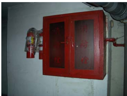
照片 4-15 消防出水口
