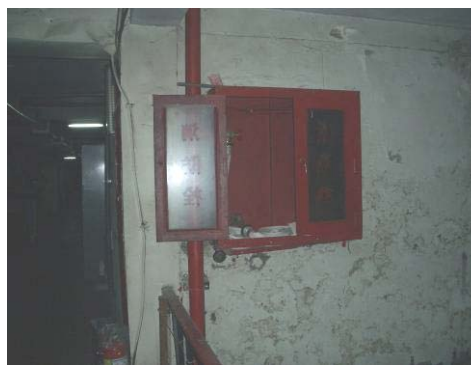
照片 4-16 消防出水口
