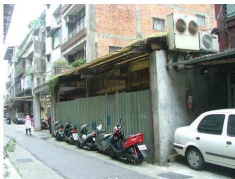
照片 4-26 社區違建情形
