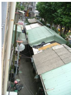
照片 4-25 社區違建情形
