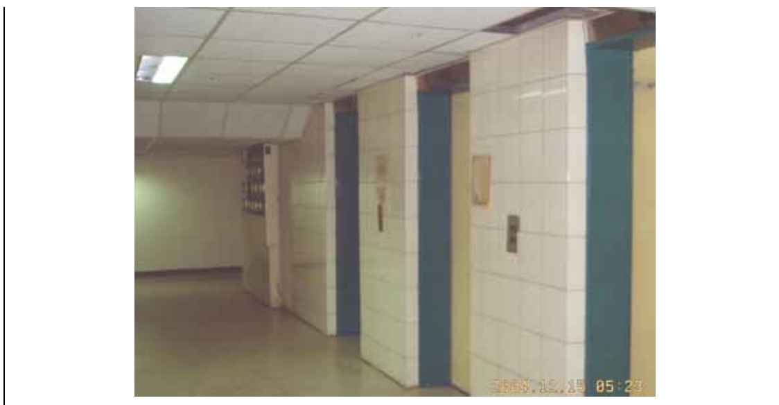
圖 5-3 走廊及通道上方天花板以可燃物裝修
