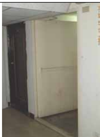
圖 5-2 室內安全梯防火門
