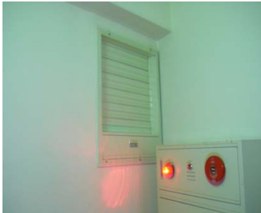
B4F 排煙閘門
