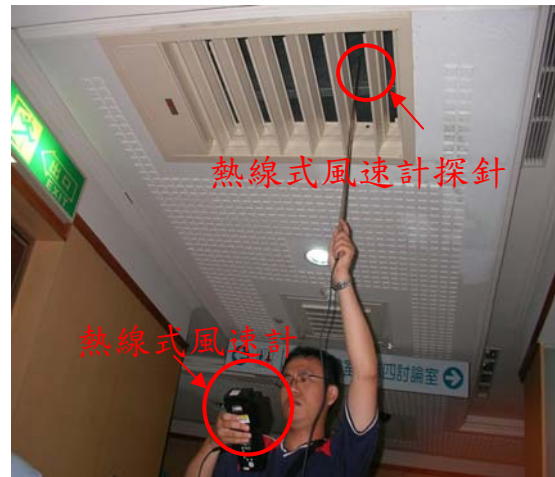
11F 排煙口風速量測
