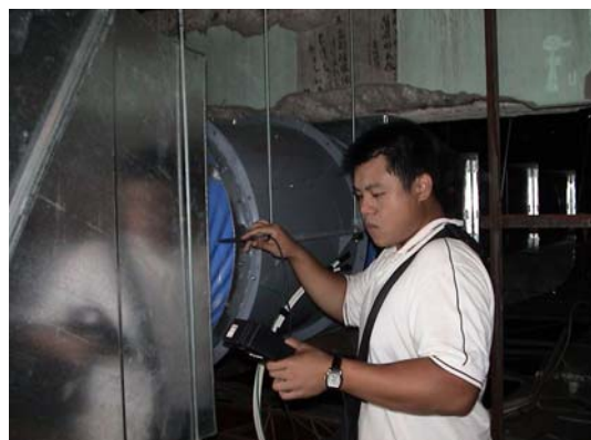
測量排煙風機流速
