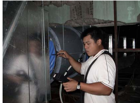
測量排煙風機流速
