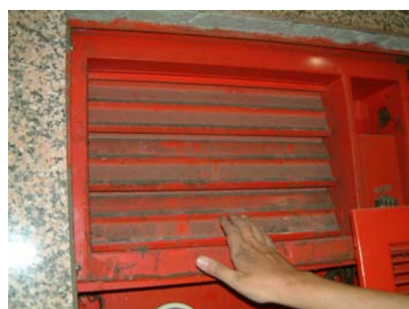
閘門密閉不良 (2)
