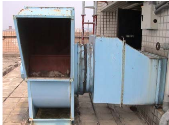
排煙風機側面照
