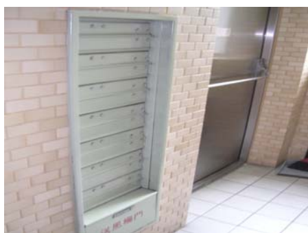
送風閘門 (進氣口)
