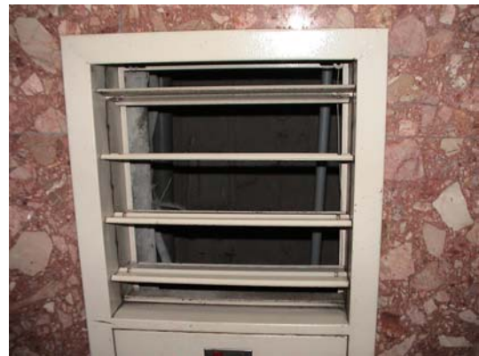
進氣閘門（開啟）
