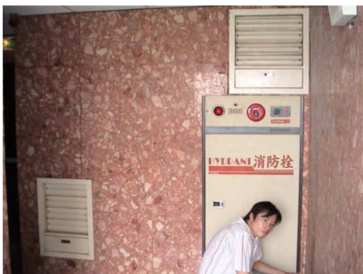
梯間排煙口與進氣口位置
