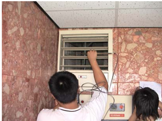
排煙口風速量測(21F)
