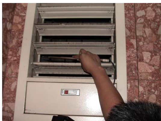
排煙口風速量測(2F)
