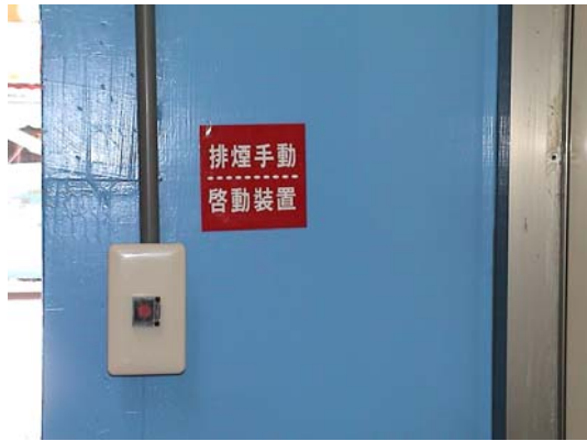
排煙裝置手動開關
