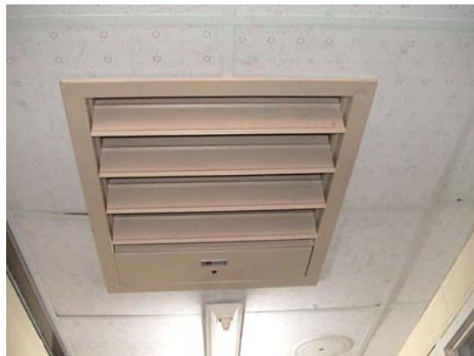
排煙閘門(開啟)
