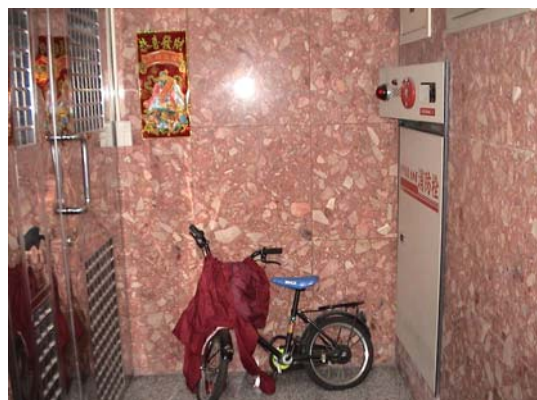
梯間緊急電源與消防栓
