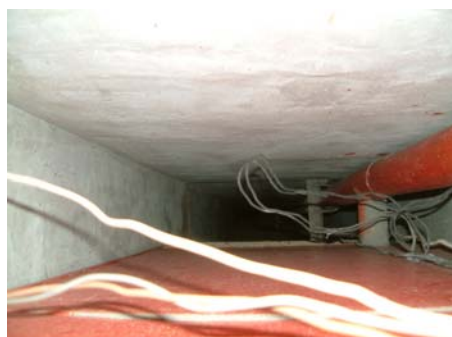
排煙管道未專用
