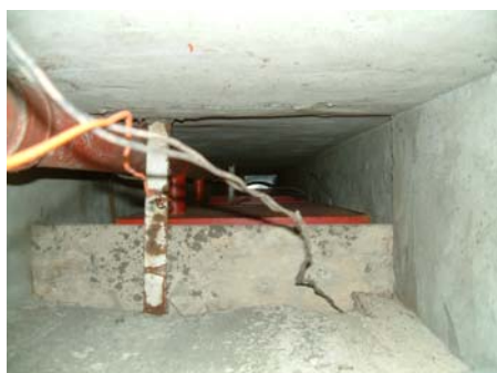
排煙管道施工不良
