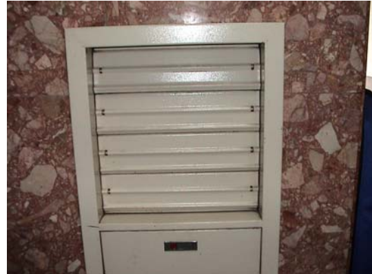
進氣閘門（關閉）
