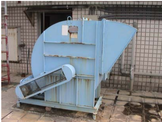
排煙風機正面照
