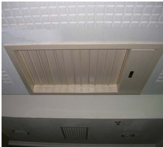
11F 排煙閘門
