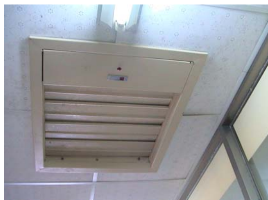
排煙閘門 (關閉)
