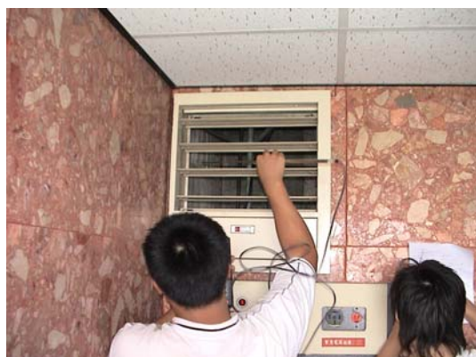
排煙口風速量測(21F)
