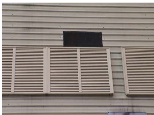
通往戶外的排煙風口
