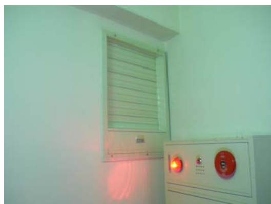
B4F 排煙閘門
