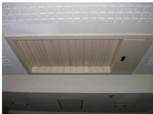
11F 排煙閘門
