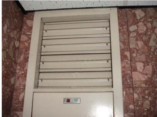
排煙閘門（關閉）
