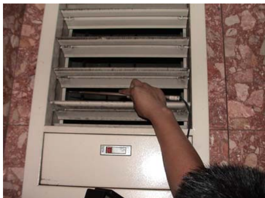
排煙口風速量測(2F)
