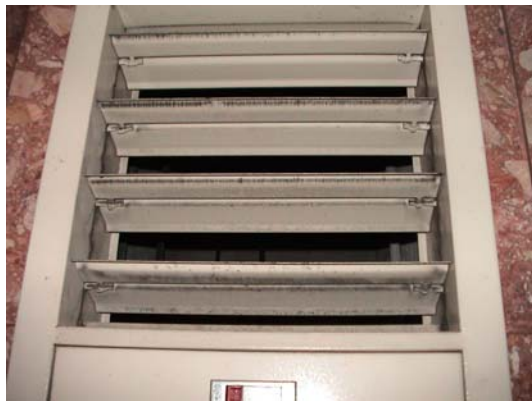
排煙閘門（開啟）
