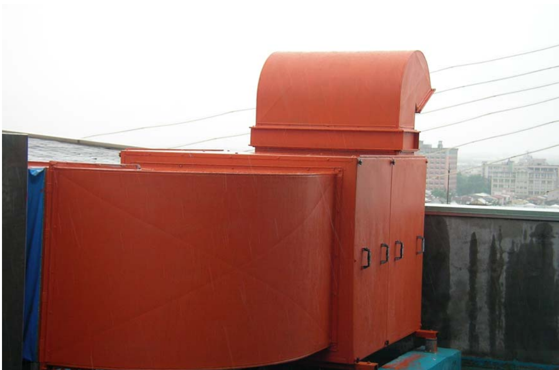
11F 頂排煙風機
