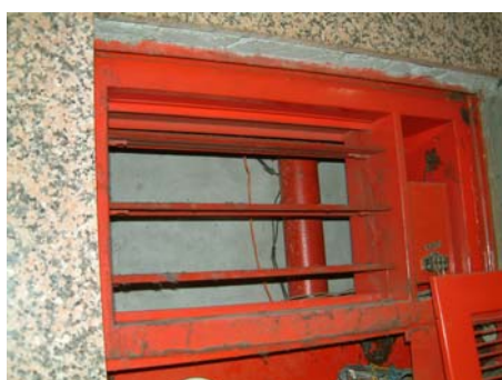
閘門密閉不良 (1)
