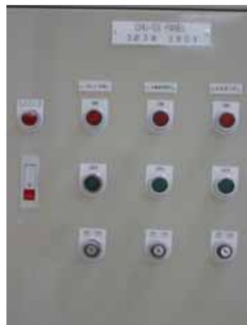
37.DDC 中央監控系統
