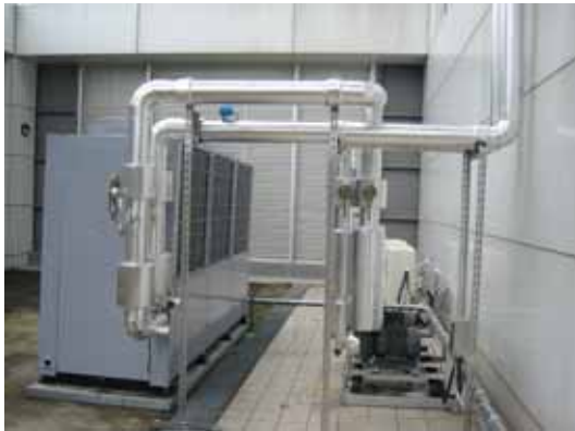
34.氣冷式冰水主機
