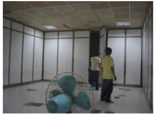
57.活動天花板掛隔屏（全）載重現況
