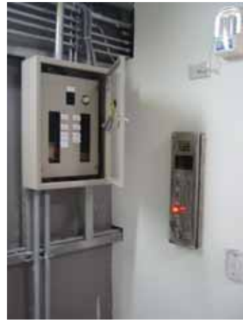
17.天花板電動升降設備及控制界面
