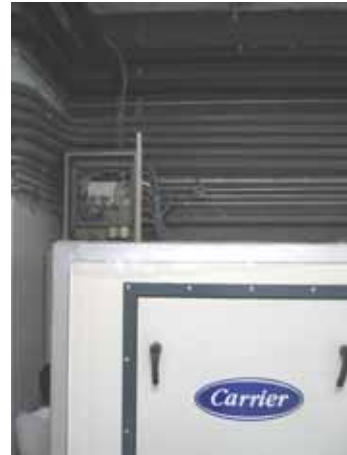
35.DDC 中央監控系統及空調箱
