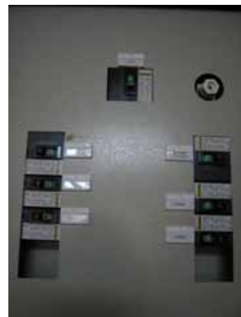
29.配光曲線實驗室電力系統控制介面
