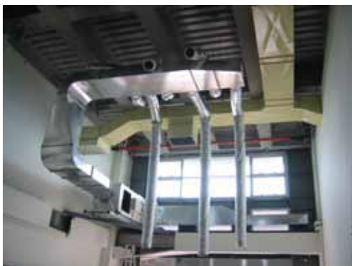
圖 2-12 配光曲線室恆溫恆濕空調系統配管
