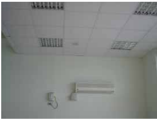
44.自然光實驗室室內空調機
