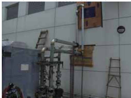
圖 3-59 空調室外主機線路配管
