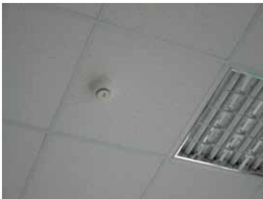
26.消防系統—偵煙器
