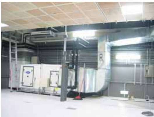
42.照明實驗室恆溫恆濕空調箱
