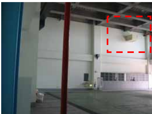
圖 2-14 原有消防排煙口
