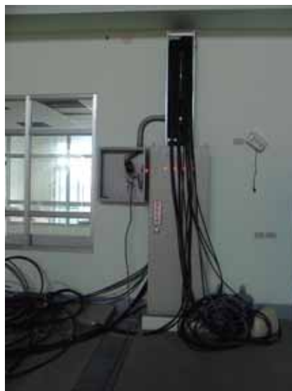
圖 3-53 總電源配電盤
