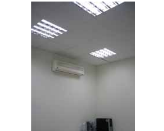
45.控制室室內空調機
