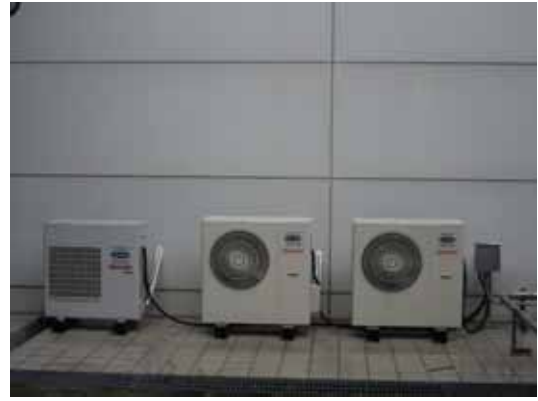
47.分離式室外機（會議室及控制室）
