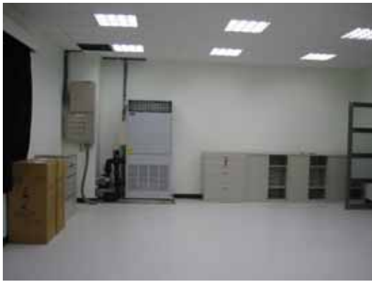
40.光源效率實驗室恆溫恆濕空調箱
