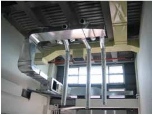
38.配光曲線實驗室恆溫恆濕系統空調配管
