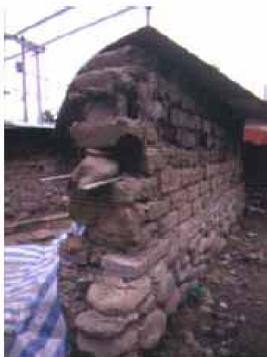
照片 2-5 竹北間禮堂，土塊牆牆基、牆體及
