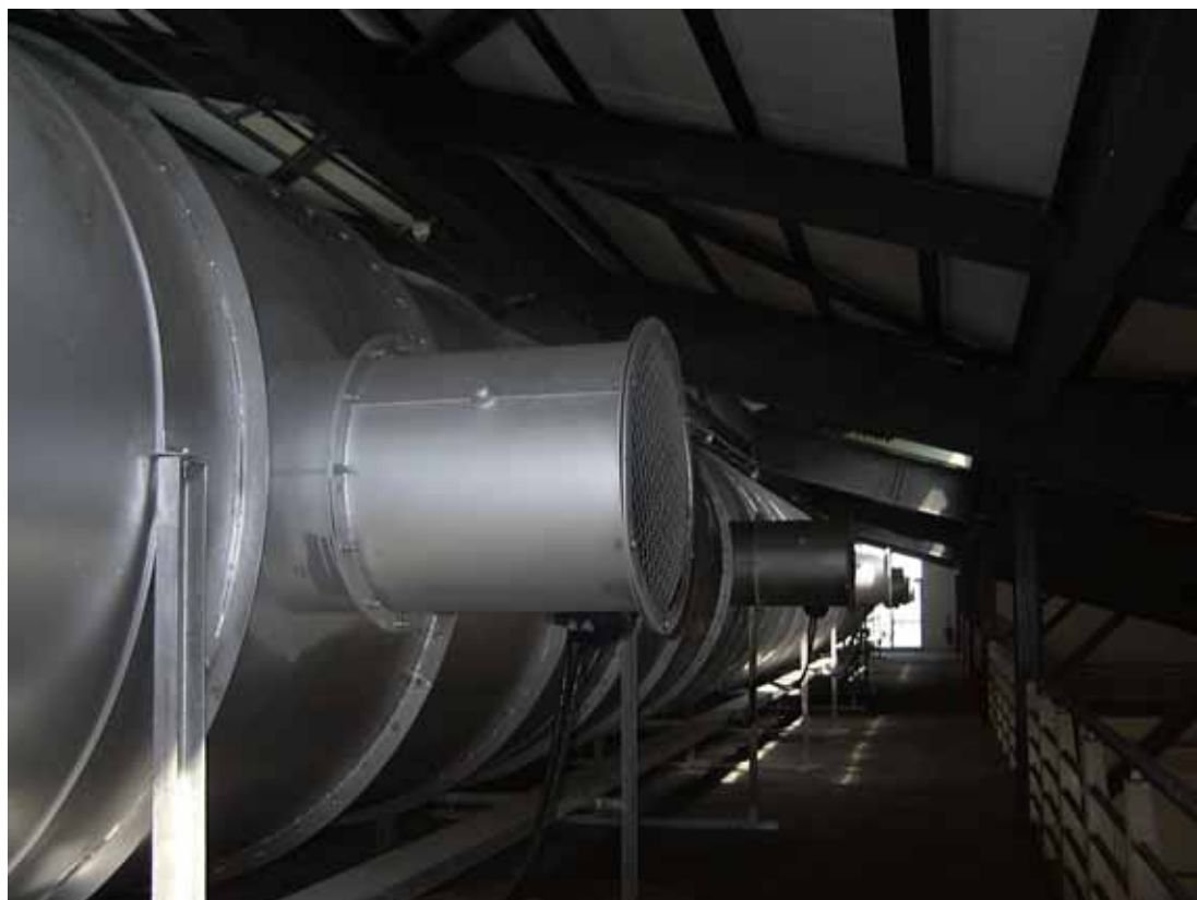
圖 2.2-3 貓道上方之機械排煙系統
