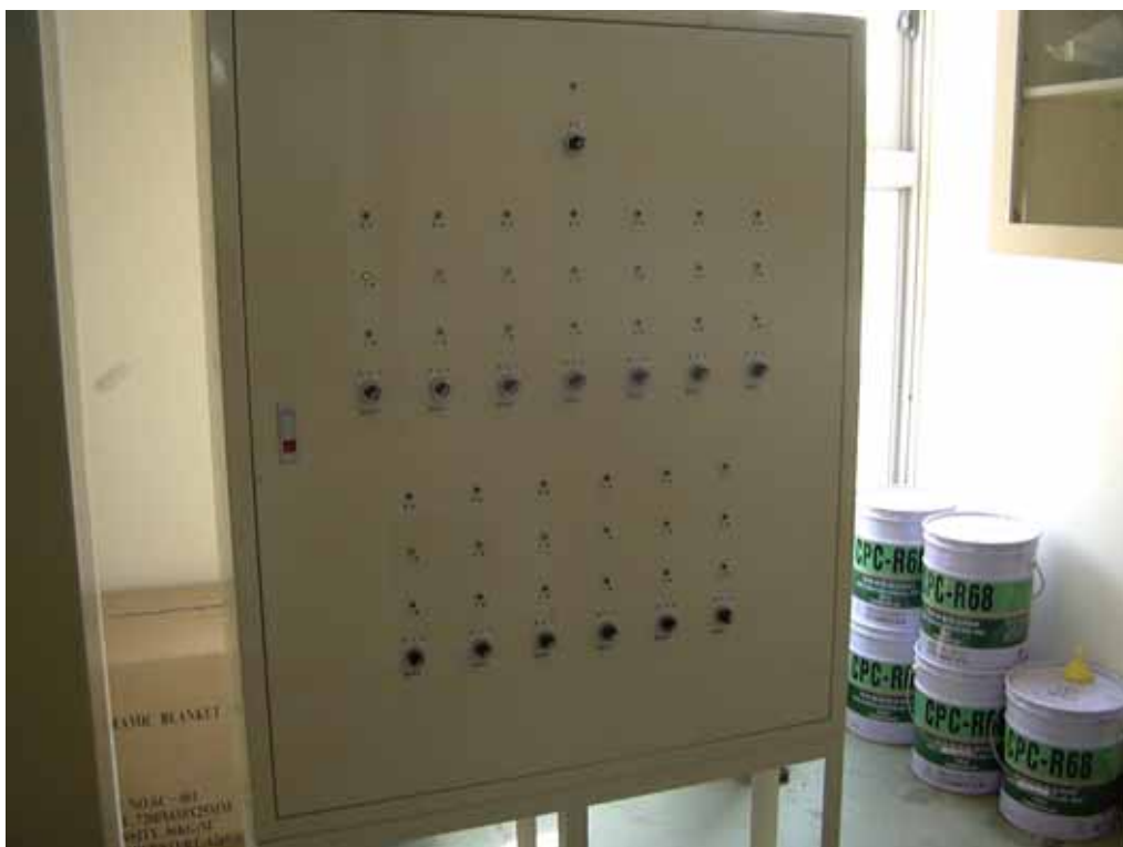
圖 2.2-4 監控室之排煙口之開啟控制盤
