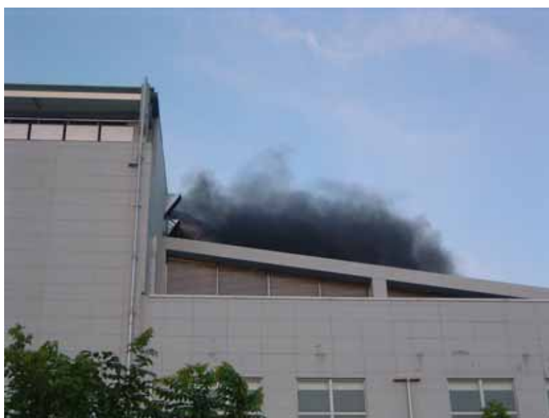
圖 2.2-7 貓道上之小型軸流式風機排煙情形
