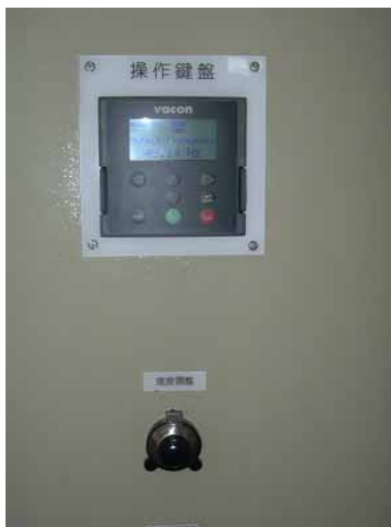
圖 2.2-5 監控室之排煙風機轉速控制盤
