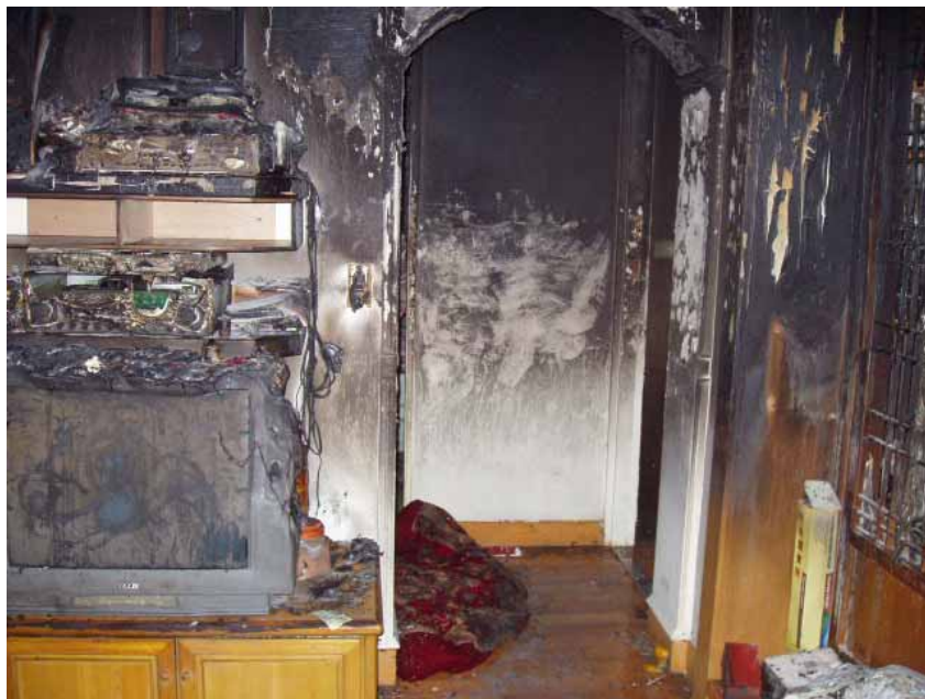
圖 3.4 避難動線燃燒情形
