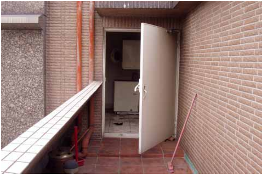
圖 3.12 西側安全梯頂部安全門
