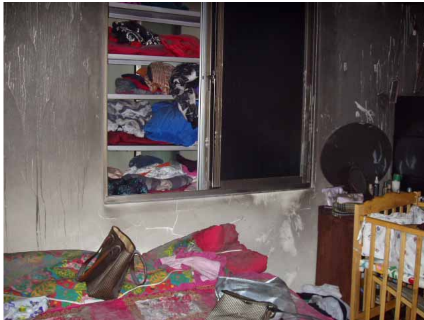
圖 3.6 窗戶堆置物品影響逃生情形
