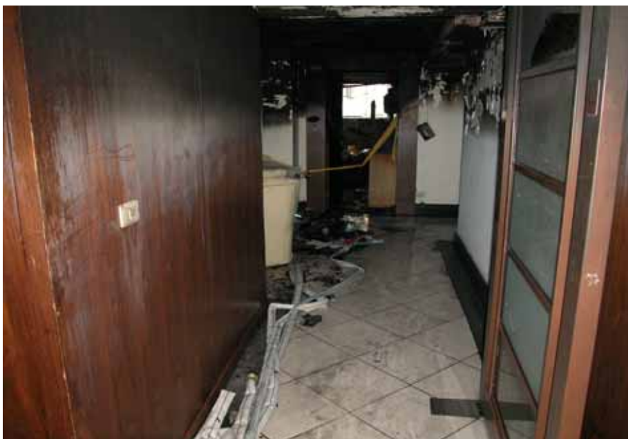
圖 3.11 起火樓層西側通道
