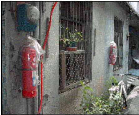
圖 5.2 滅火器的設置
