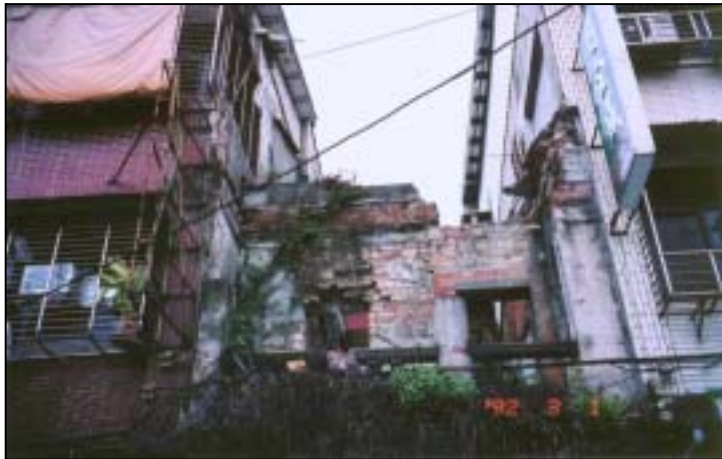
附錄圖 5.7 勘查照片之四（缺乏維護與補修導致結構鬆散）
