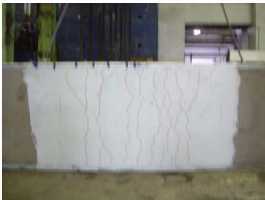
照片 4-4.22 SC1 試體試驗後裂縫發展情形
