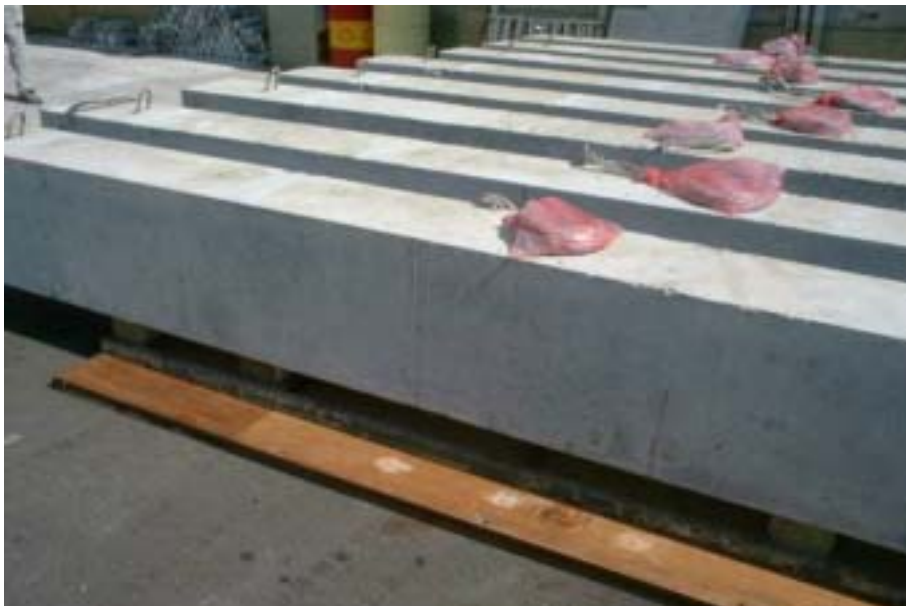
照片 4-3.17 混凝土硬固後梁試體外觀圖
