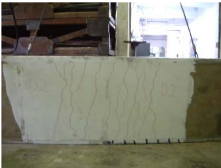
照片 4-4.25 SD2 試體試驗後裂縫發展情形
