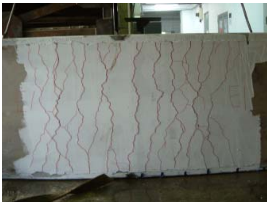
照片 4-4.26 SE1 試體試驗後裂縫發展情形
