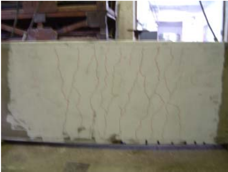
照片 4-4.23 SC2 試體試驗後裂縫發展情形
