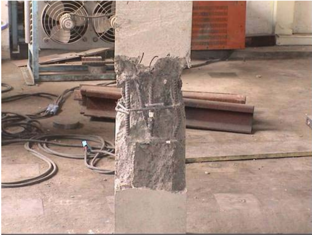
照片 4-5.9 LC1 破壞狀況
