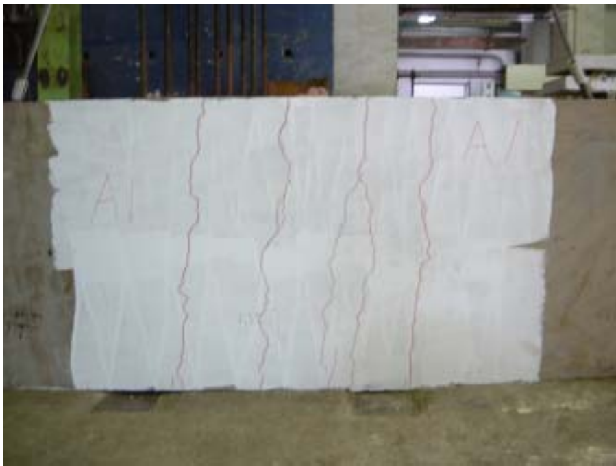
照片 4-4.14 SA1 試體試驗後裂縫發展情形
