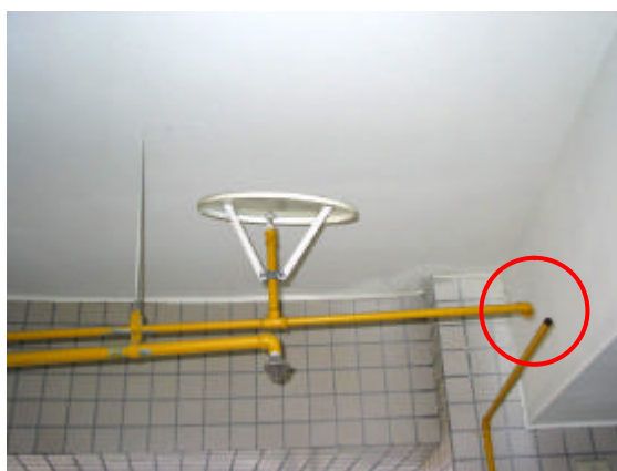
照片 3.17 配管與手動啟動閥相接處之破壞照片
