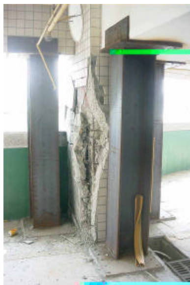
照片 3.3 唯一一根可見內層鋼筋之柱破壞(肆樓)
