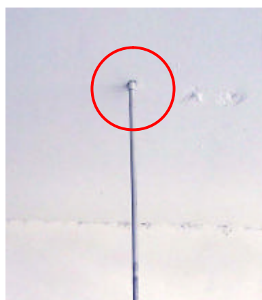
照片 3.8 膨脹螺栓式吊桿
