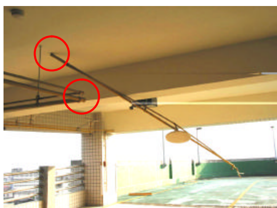
照片 3.18 泡沫放射區域單元局部斷裂照片
