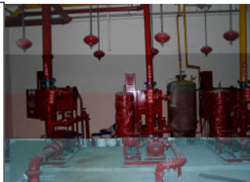
照片 3.20 地下室機械設備
