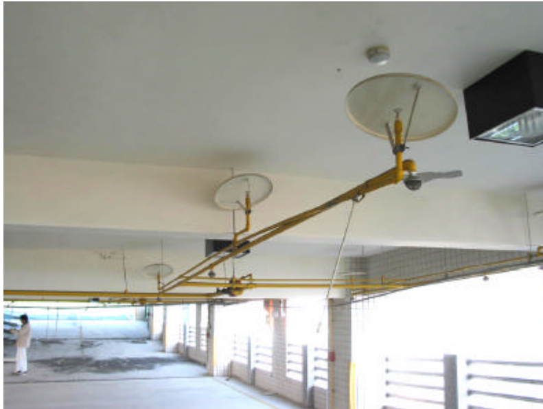
照片 3.2 建築物內部之自動滅火設備
