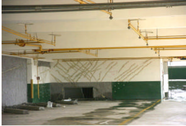
照片 3.4 牆面之破壞情形
