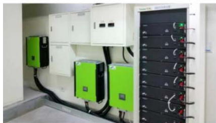
地下室機電空間裝設儲能系統
