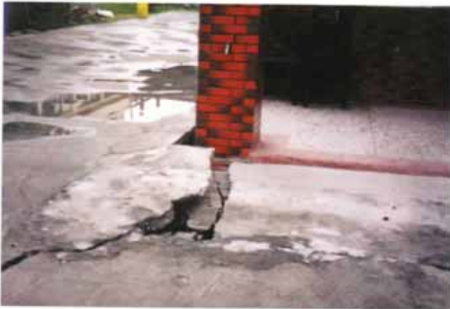
照片編號2.14 員林鎮崙雅巷建築物因土壤液化而沉陷
