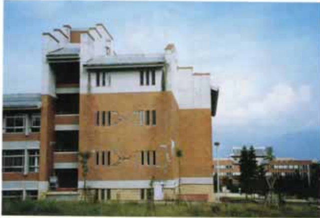
照片編號1.19 國立暨南大學某教學大樓外牆受剪力破壞情形
