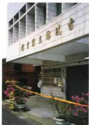
照片編號I.97 古坑鄉立圖書館柱損壞情形
