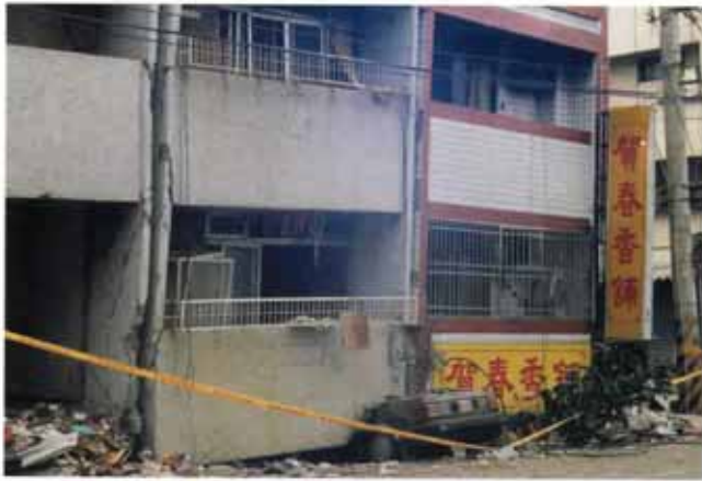
照片編號1.67 霧峰騎樓建築，一樓產生破壞(一)
