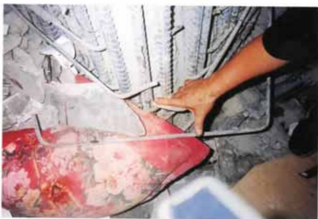
照片編號2.7 箍筋彎鉤角度不符規定
