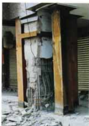
照片編號1.2 美滿大廈為12層連棟集合住宅，一樓部分騎樓柱爆裂
