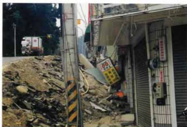
照片編號1.51 台中縣豐原市水源路部份路段，因受斷層通過而路面隆起
