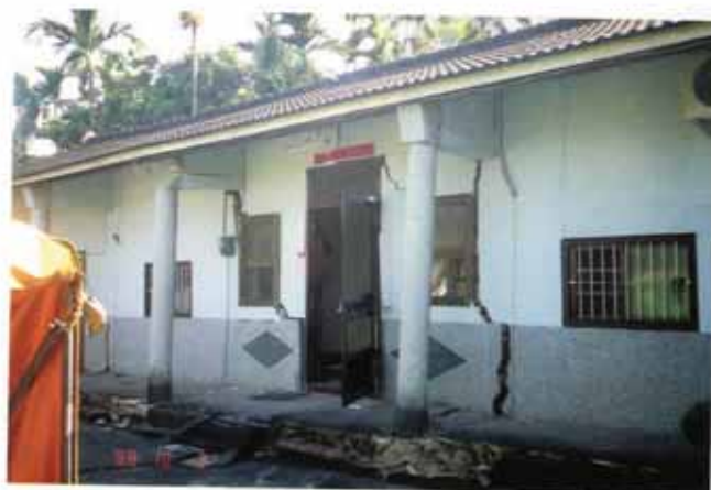
照片編號1.35 房屋在斷層旁。典型鄉村住宅型式，迴廊柱之柱頭、柱基及柱樑交接均損壞
