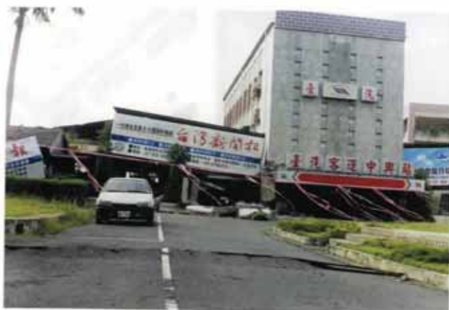
照片編號1.18 臺汽客運中興站一樓開放空間壓毀破壞
