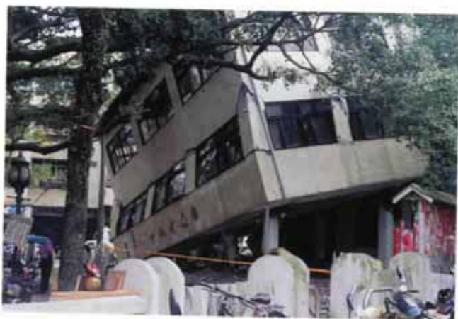
照片編號1.7 南投市老人會一層挑空軟弱層，整體壓毀傾倒
