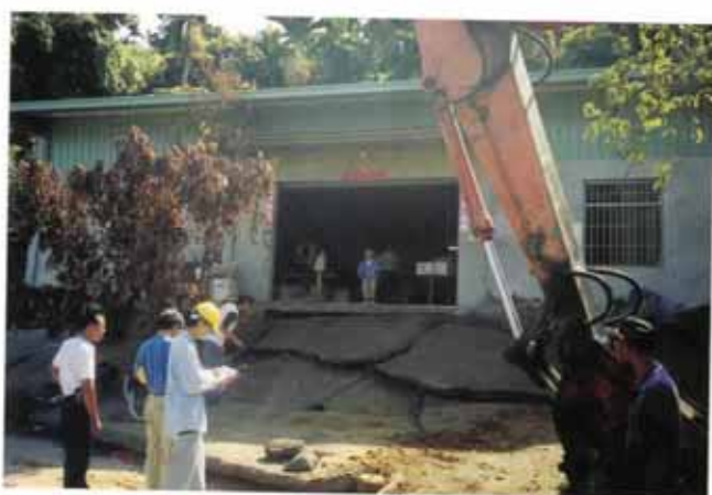
照片編號1.33 斷層帶通過，房屋往西移約4m，且平均隆起約1.5m，房屋本身仍完整
