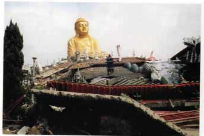
照片編號1.65 霧峰萬佛寺整體倒塌
