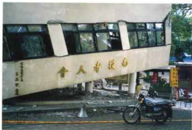
照片編號2.2 一樓軟弱層(開放空間)
