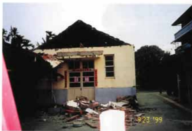
照片編號1.96 古坑民宅毀壞
