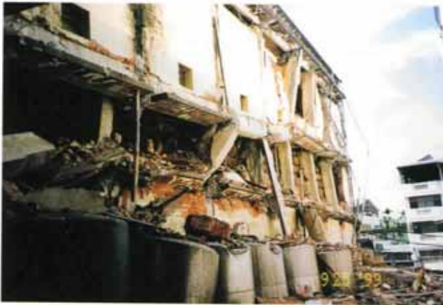
照片編號1.20 埔里酒廠老舊建築荷重太大震害嚴重
