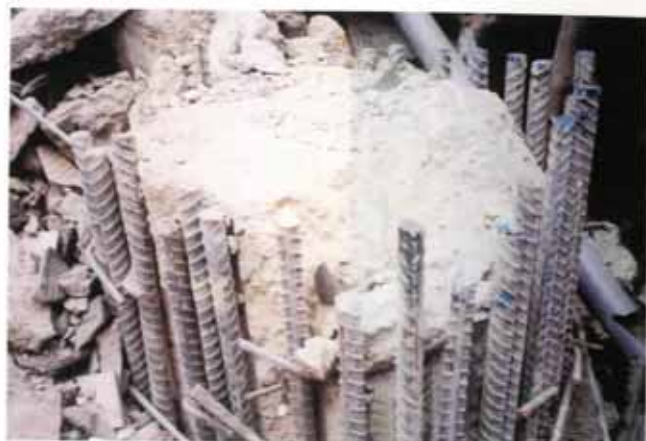
照片編號2.10 新莊博士的家柱主筋於同一處搭接
