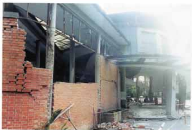
照片編號2.3 磚牆之破壞
