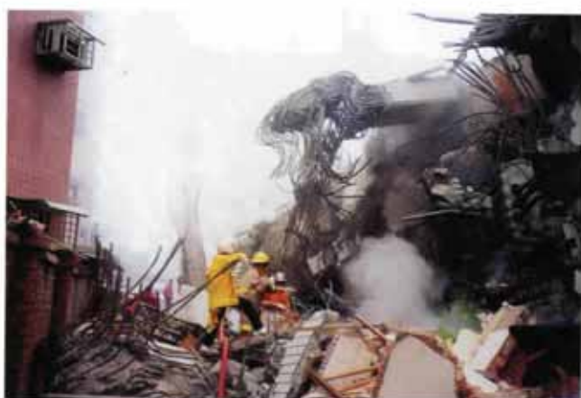
照片編號1.80 博士的家一樓柱於柱主筋搭接處脫離，建築物倒傾
