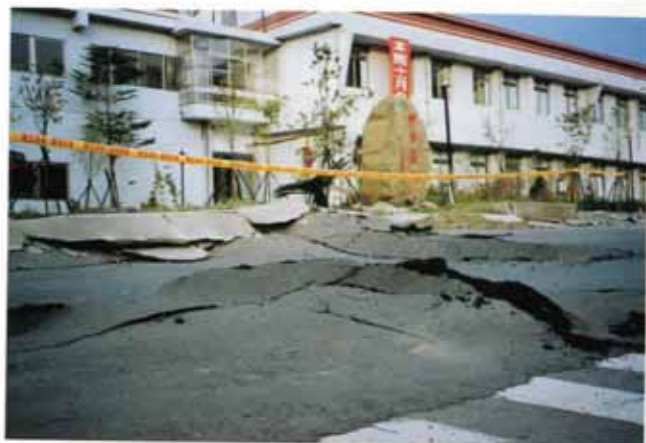
照片編號1.16 省立中興醫院位置地層隆起，造成建築損害
