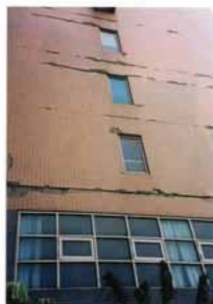
照片編號1.54 台中縣豐原市德川家康大廈牆面，產生水平裂縫
