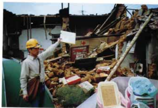
照片編號1.77 新社民宅土塊厝耐震能力不足，整體倒塌（台大NTU02509-1）
