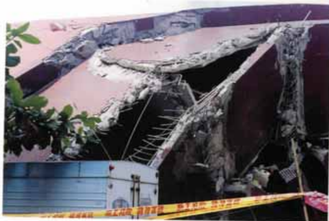
照片編號1.10 國泰人壽大樓不均勻沉陷，傾倒後樓板外牆破壞情形
