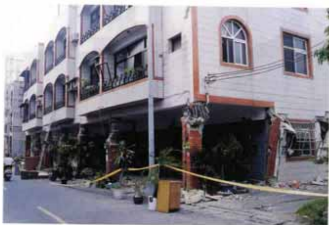
照片編號1.15 某連棟住宅騎樓柱頭嚴重破壞，並已扭曲傾斜
