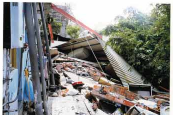
照片編號1.42 廚房後加建部分，因地層隆起，結構物下滑並嚴重損壞（台大NTU25009-4）
