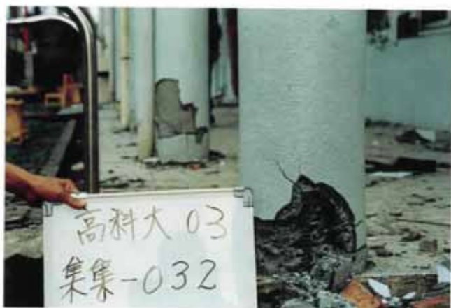
照片編號1.29 集集國小走廊柱頭破壞(高科大KFUI3036d)
