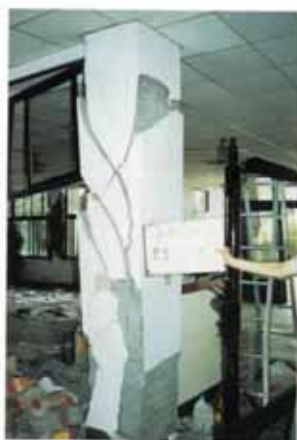
照片編號1.30 集集警察局內柱剪力破壞(高科大KFUI3017c)
