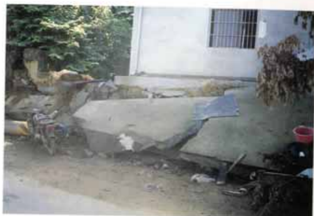
照片編號1.34 斷層帶通過，房屋往西移約4m，且平均隆起約1.5m，房屋本身仍完整
