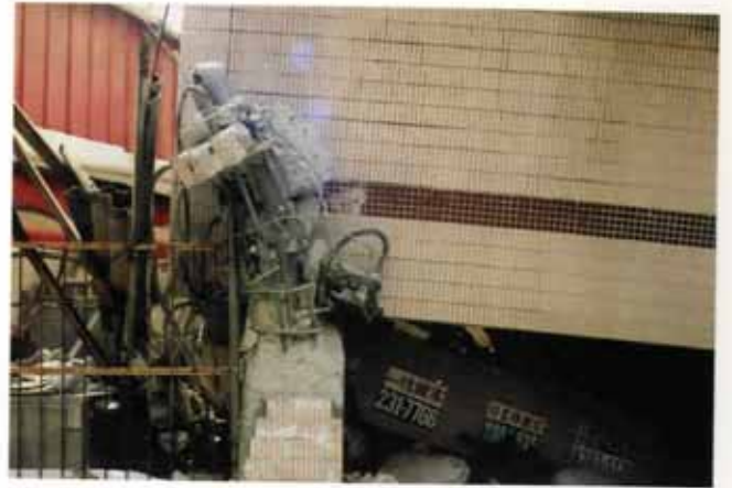
照片編號1.64 裝飾石材之剝落
