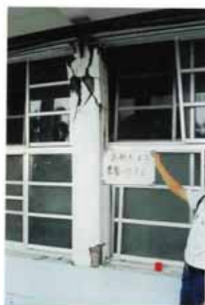
照片編號1.28 集集國小教室柱端破壞情形 (高科大KFUI3036C)
