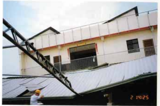
照片編號1.40 地層隆起，房屋傾斜，並嚴重損壞（台大NTU25010-2）
