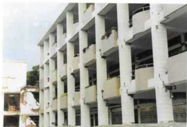
照片編號2.11 樑柱接頭之破壞
