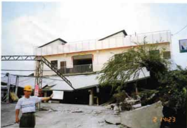
照片編號1.39 地層隆起，房屋傾斜，並嚴重損壞（台大NTU25010-1）
