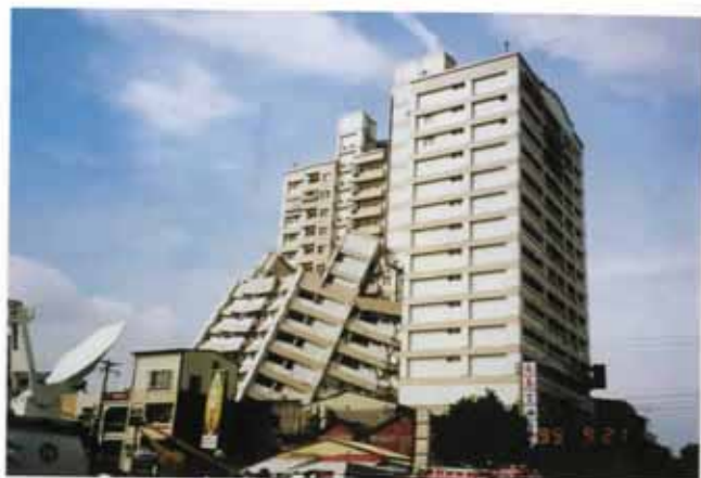
照片編號1.88 員林龍邦富貴名門建築物崩塌
