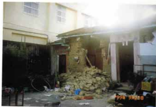
照片編號1.76 東勢老舊土塊厝建築破壞
