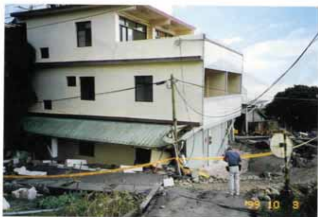
照片編號1.43 地盤基礎隆起，房屋傾斜
