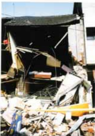
照片編號2.15 老舊磚造建築破壞情形
