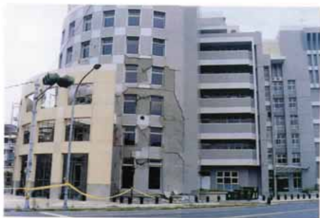
照片編號1.3 南投新建圖書館圓形轉角部分剪力破壞，磁磚剝落，後半部損害輕微大致完好
