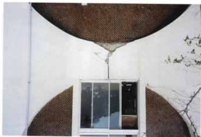
照片編號1.86 台北市景美女中體育館外牆龜裂
