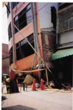
照片編號1.26 國姓鄉街角民宅側傾
