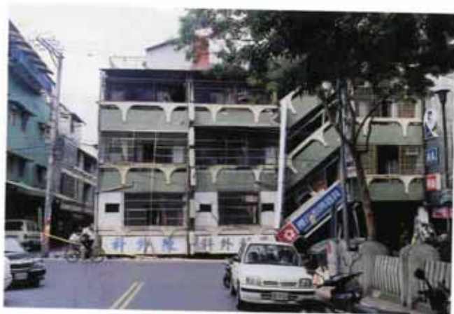
照片編號1.9 某轉角店舖住宅一樓整體壓陷
