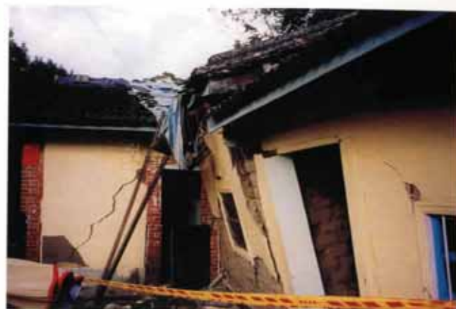
照片編號1.46 土塊層傾倒，牆壁裂開，隨時有倒塌之虞
