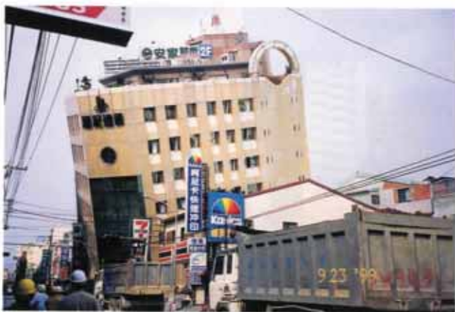
照片編號1.92 斗六漢記辦公大樓傾斜
