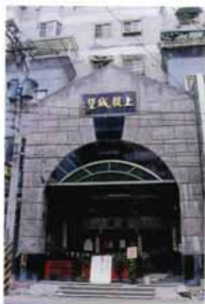
照片編號1.1 上穀城堡為高層集合住宅，一層部份騎樓柱頭剪力破壞
