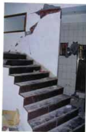
照片編號1.12 南投市一般低層透天的店舖，一樓中間轉折樓梯及磚牆破壞，為受損建物常見現象
