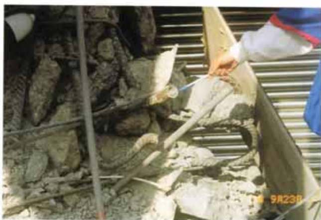
照片編號2.9 鋼筋續接器品質不良
