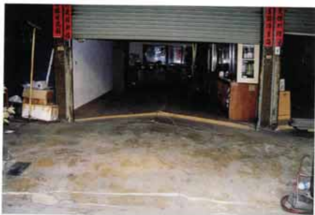
照片編號1.13 南投市一般低層之店舖住宅，一樓地坪隆起、柱腳沉陷破壞
