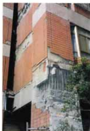
照片編號1.53 台中縣豐原市尊龍大樓，樑柱接合處破壞情形
