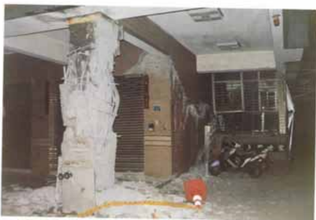
照片編號1.32 上穀世家於921主震中騎樓柱破壞情形，又未緊急支撐，已於926餘震中完全倒塌
