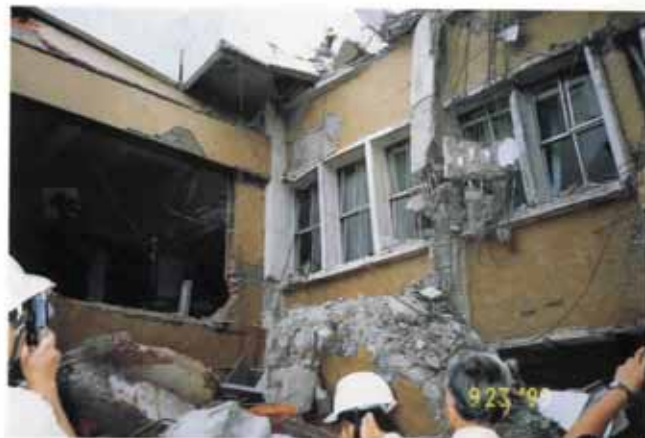
照片編號1.95 古坑鄉公所損壞情形
