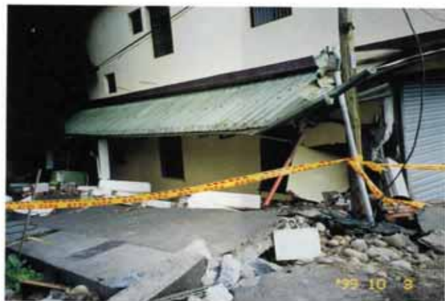
照片編號1.44 地盤基礎隆起，房屋傾斜（近照）
