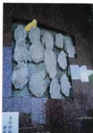
照片編號2.4 裝飾石材之剝落
