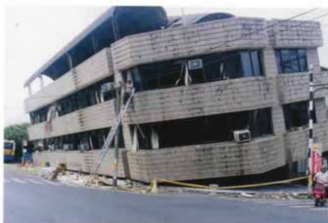
照片編號1.5 水土保持局第三工程隊辦公室，一樓完全壓垮
