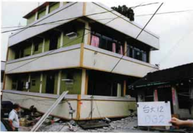
照片編號1.37 草屯民宅（一樓含騎樓），一樓完全倒塌（台大草032）
