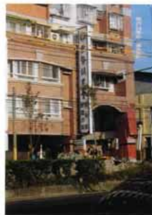
照片編號1.72 東勢王朝二期一樓柱毀壞
