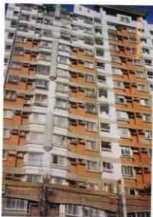
照片編號1.73 東勢王朝二期因部分一樓柱破壞，造成立面產生側移傾斜
