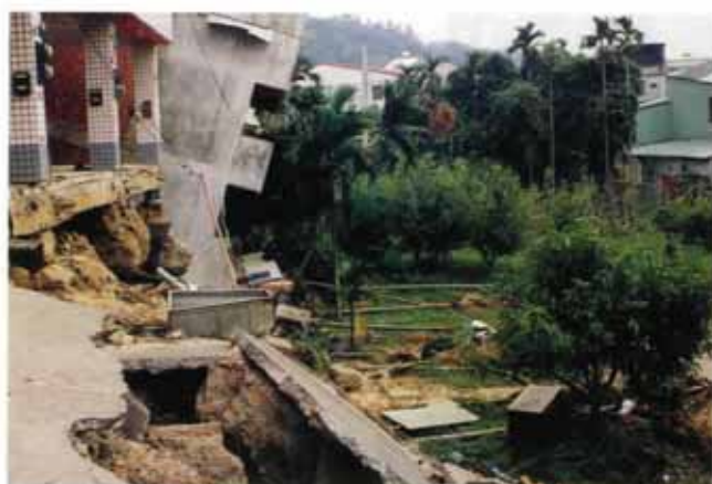
照片編號1.49 台中縣豐原市民宅因斷層經過，地層受擠壓而隆起，造成地面嚴重破裂，建築物基礎外露
