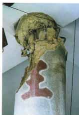
照片編號2.12 混凝土品質不良
