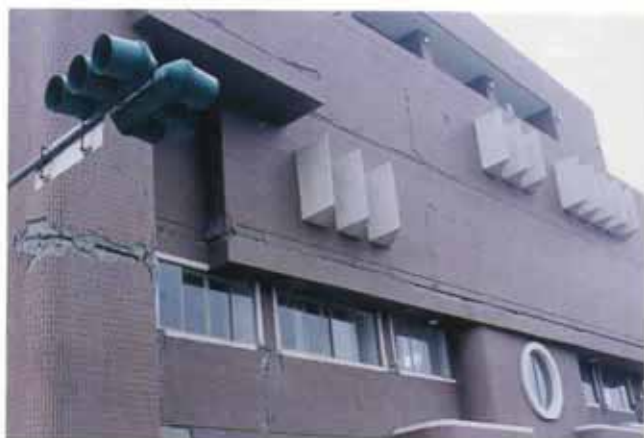
照片編號1.4 南投青少年活動中心二樓層間位移，四周外牆明顯龜裂
