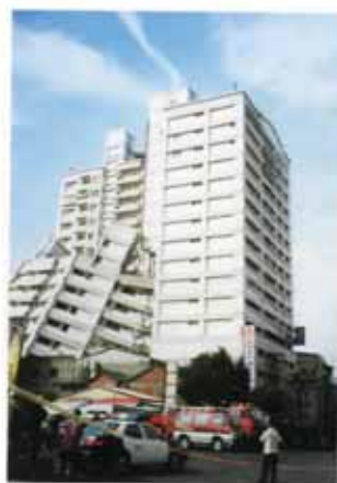
照片編號1.89 龍邦富貴名門高層集合住宅，後棟大樓1-8樓壓毀，整體傾倒
