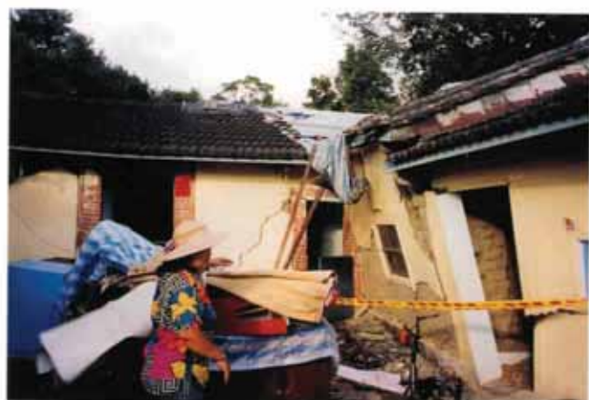
照片編號1.45 土塊層傾倒，牆壁裂開，隨時有倒塌之虞
