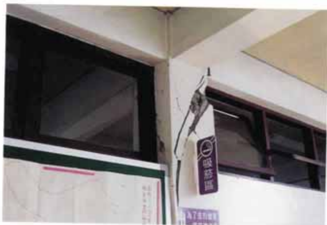
照片編號1.8 南投縣政府辦公大樓，內部部分柱產生短柱效應造成破壞
