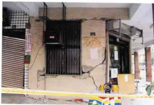
照片編號1.14 某轉角診所嚴重損害情形
