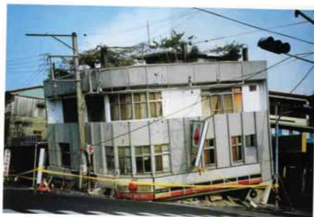
照片編號1.11 臨街轉角之騎樓建築整體傾倒壓毀，為本次地震災區之破壞現象
