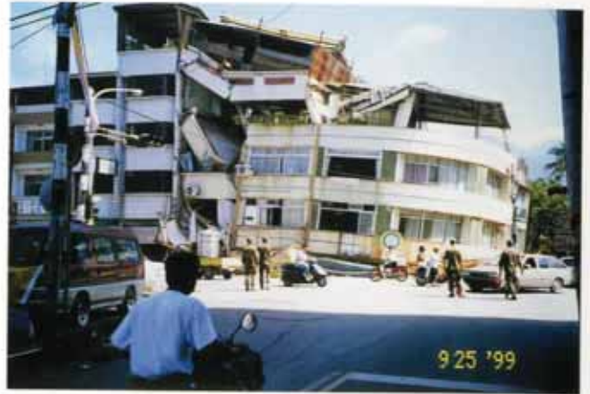
照片編號1.22 埔里鎮上「三角窗」民宅傾倒情形
