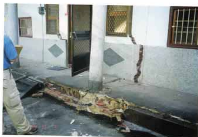
照片編號1.36 房屋在斷層旁。典型鄉村住宅型式，迴廊柱之柱頭、柱基及柱樑交接均損壞
