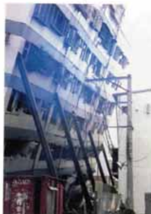
照片編號1.58 台中王朝傾斜，建築緊急補強，以免危及鄰棟
