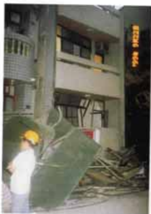
照片編號1.75 東勢鎮騎樓建築，一樓產生破壞
