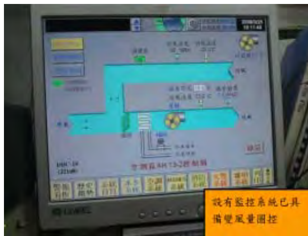
圖 5.1-5 中央聯合辦公大樓南棟空調監控系統畫面
