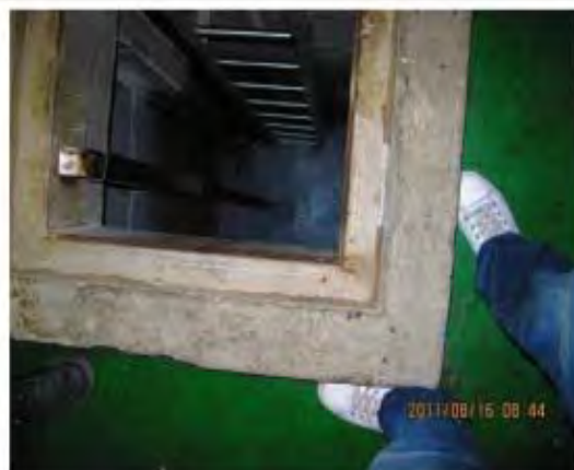
改善前儲冰槽儲冰顯示情況
