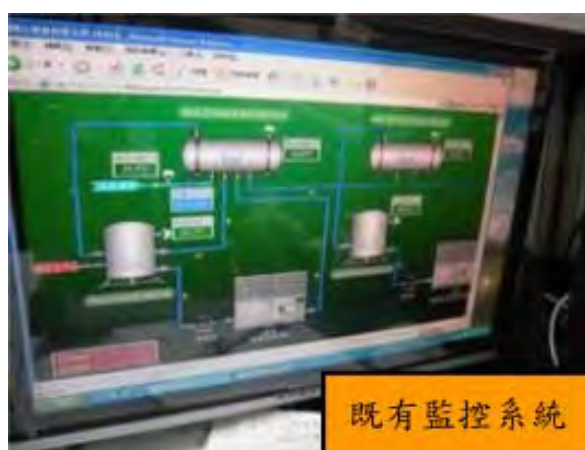
圖 5.6-4 國立屏東科技大學學生宿舍熱水系統既有監控
