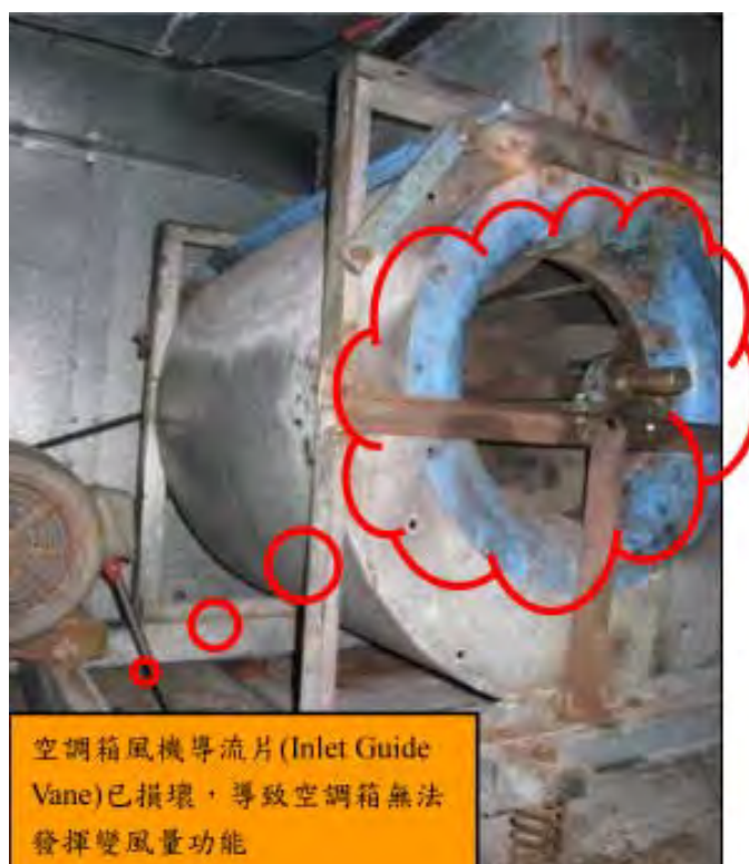
圖 5.1-3 中央聯合辦公大樓南棟空調箱風機
