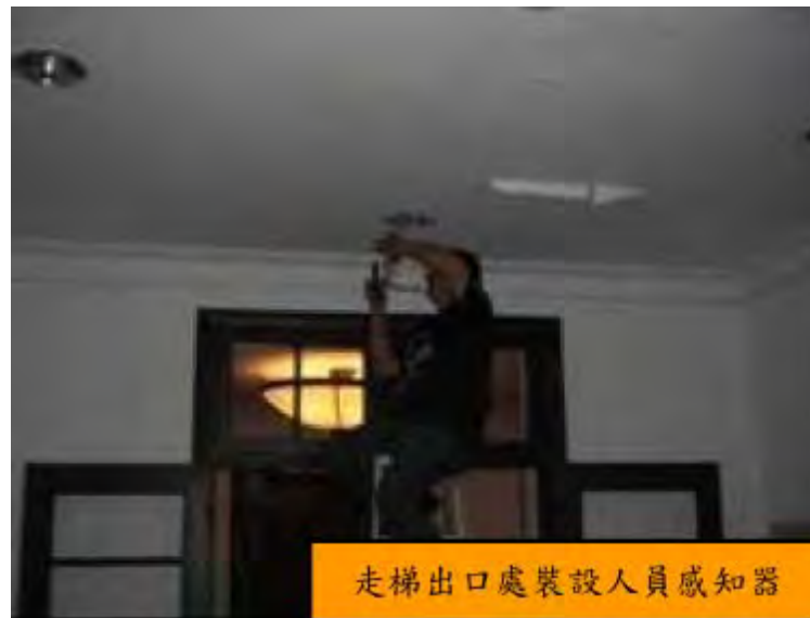
圖 5.2-8 總統府照明系統改善對策－走梯出口加裝人員感知器
