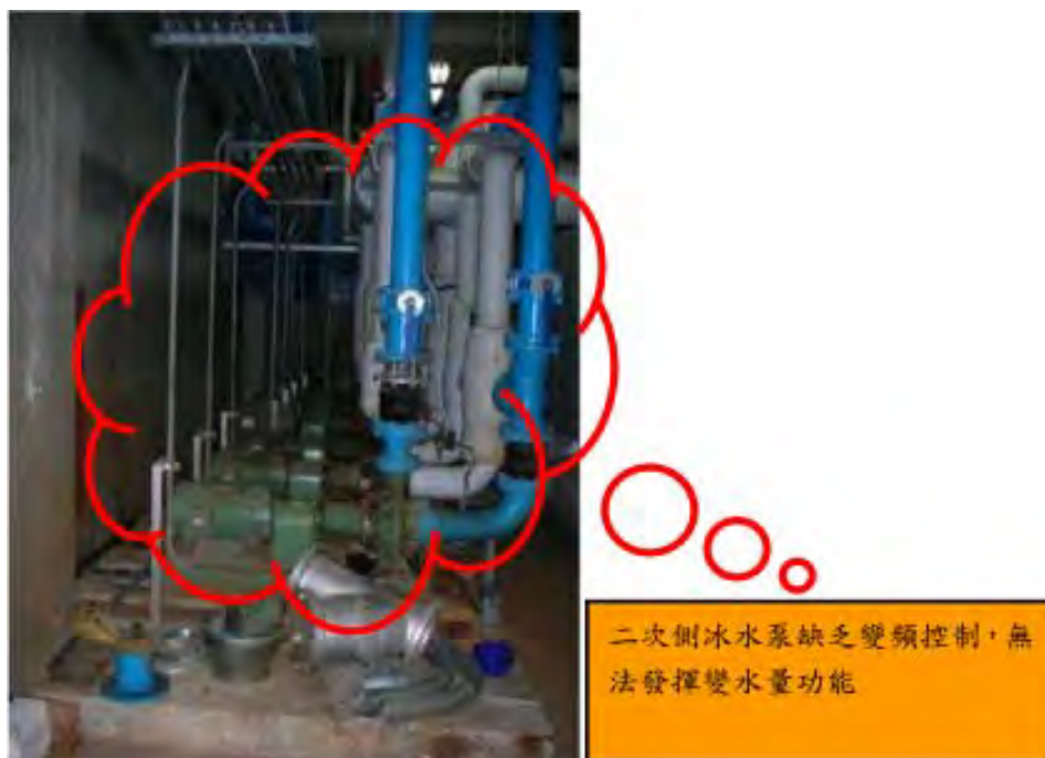
圖 5.3-2 國立台灣大學圖書館空調系統區域冰水泵
