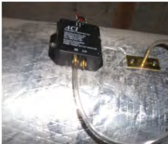
增設壓差感測器
