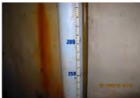
改善前儲冰槽水位融量顯示情況
