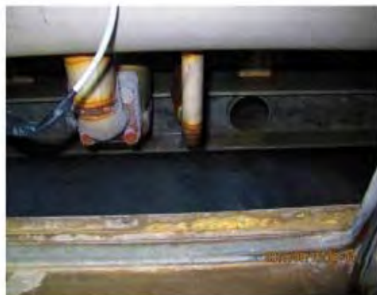
改善前儲冰槽儲冰顯示情況
