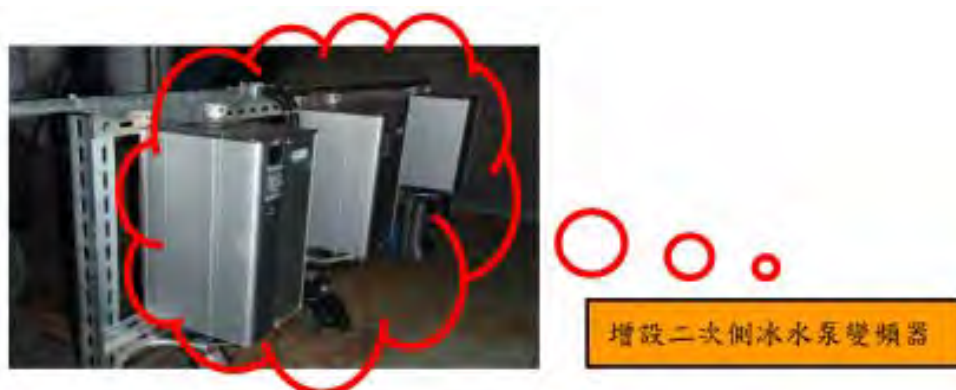
圖 5.3-3 國立台灣大學圖書館空調系統區域冰水泵
