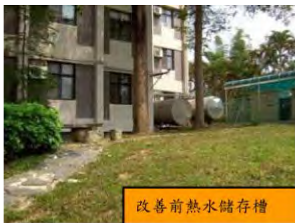
圖 5.6-1 國立屏東科技大學學生宿舍改善前熱水儲存槽
