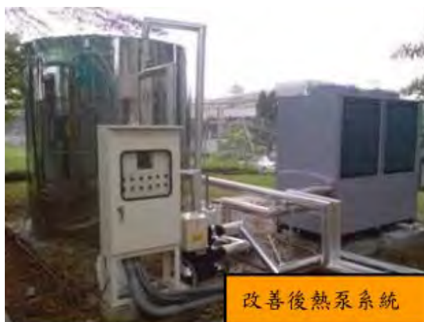
圖 5.6-3 國立屏東科技大學學生宿舍改善後熱泵系統
