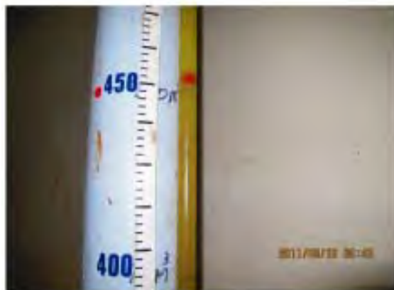
改善前儲冰槽水位融量顯示情況
