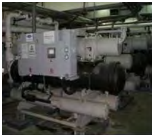
圖 5.5-1 行政院衛生署朴子醫院螺旋滿液式冰水主機
