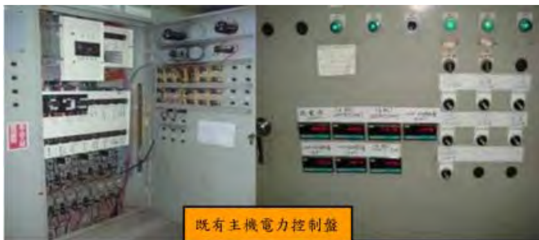
圖 5.5-2 政院衛生署朴子醫院空調系統動力盤
