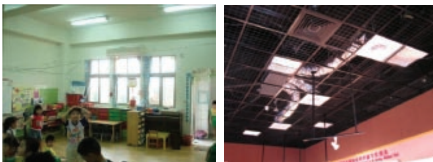
圖3-30 某休閒文教類室內空調設置不當造成室內溫度分布不均
