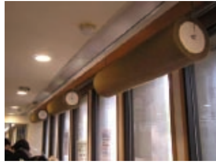
2. 影印室內裝設吸音筒
