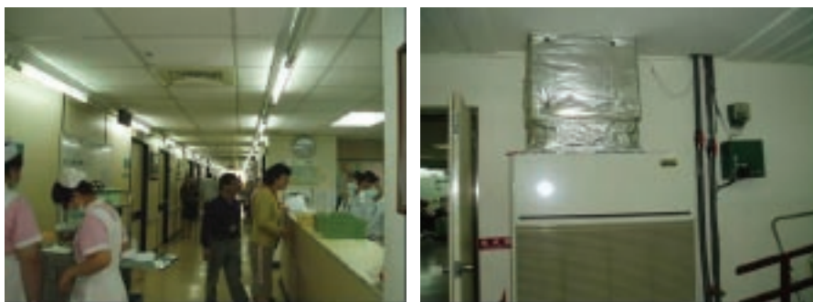
圖3-17 某衛生福利類室內之噪音源自人員活動及空調主機噪音
