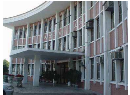
圖4.31 行政大樓連北向立面日曬都嚴重，遑論南向?(改善前)
