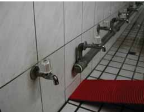
圖4.47 一般常見的水龍頭形式(改善前)
