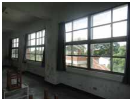
圖4.29 改善前製圖教室眩光嚴重(改善前)
