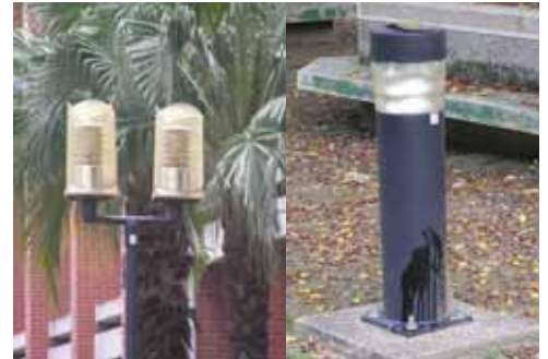
圖4.37 使用160W*2水銀燈的路燈及60W白熾燈的步道矮燈，照明效率差且全面漫射的燈具設計亦影響週遭環境。(改善前)
