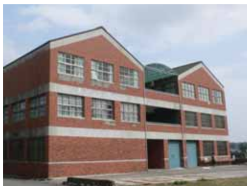
圖4.27 缺少外遮陽的建築科館，陽光直達室內(改善前)
