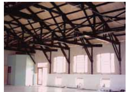
圖4.44 經修復可表現結構之美的木構造(改善後)
