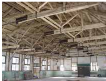
圖4.43 原有破舊的木構造(改善前)
