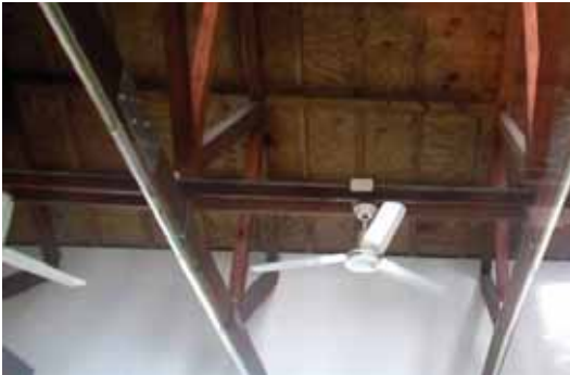
圖5.43 架設電風扇有助於空氣流動
