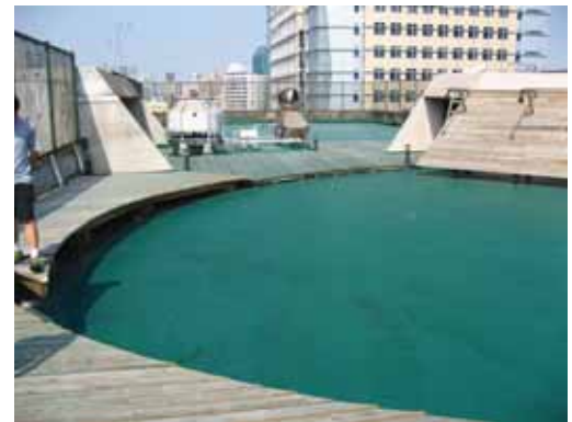
圖4.33 昌明樓屋頂日曬嚴重之貌(改善前)
