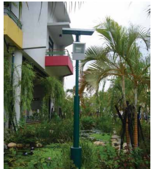
圖5.76 入口生態池邊設置太陽能燈，白天蓄電，可供夜間入口照明，頗富教學示範作用。
