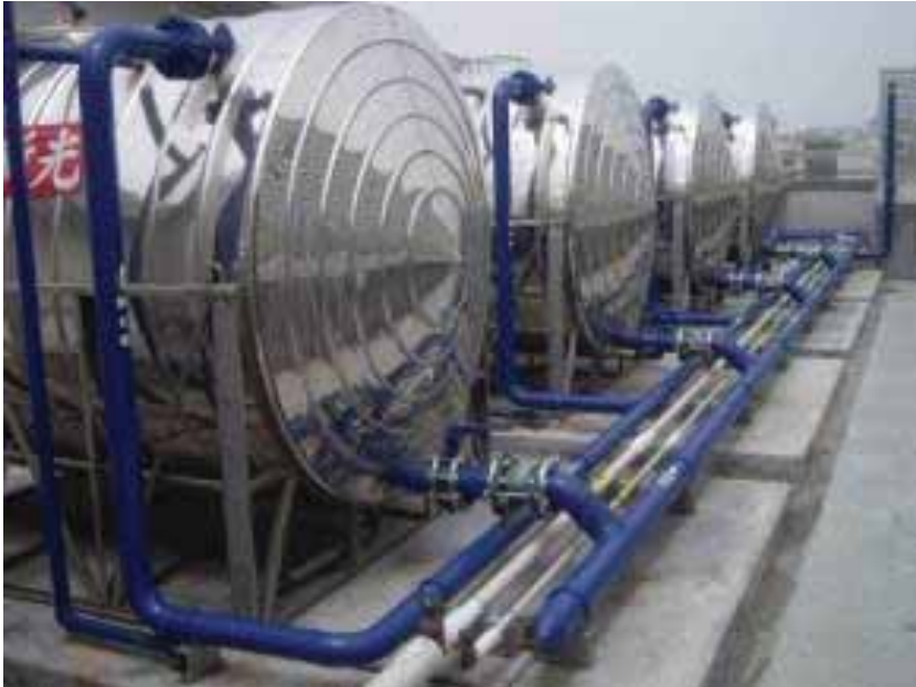
圖5.73 屋頂水塔採架高的方式可有效散熱及減少機具振動所造成的屋頂層漏水問題。
