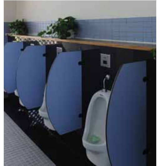
圖5.75 全校的廁所皆使用二段式省水馬桶和節水設備，屋頂的雨水經過建築物上的綠色水管，回收至地下室的儲集槽，再以馬達抽水使用在廁所、澆灌植物。
