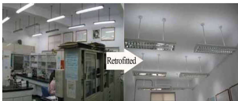
圖4.52 以高效率T5燈源搭配高反射燈具及電子式安定器，取代原有T8燈管之照明改善手法
