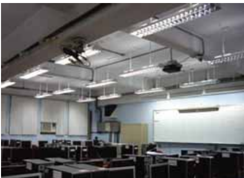
圖4.36 教室照明改善後使用T5日光燈管，效率提升並有防眩光格柵。(改善後)
