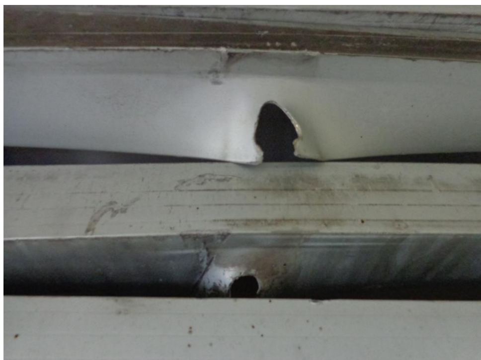
圖 2-8 面板框架與支撐架接合處之破壞
