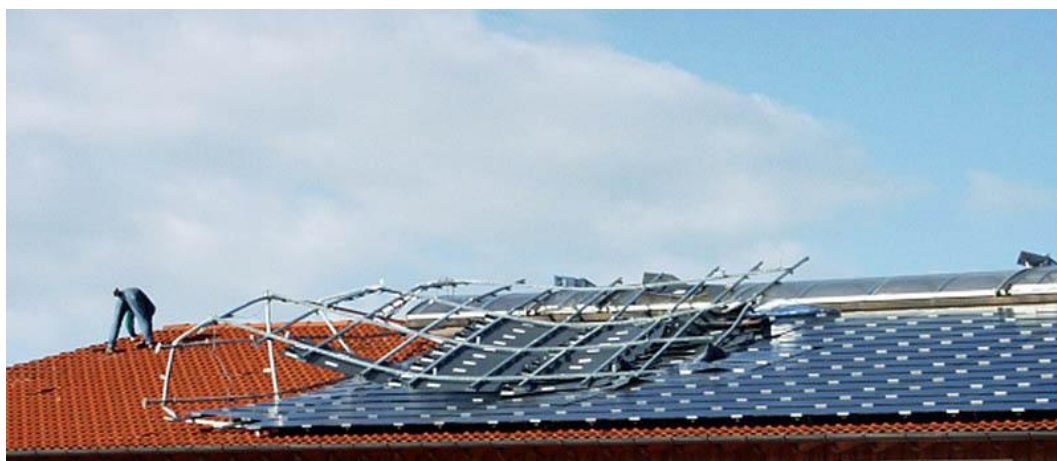
圖 2-6 支撐架與屋頂面接合處之破壞
