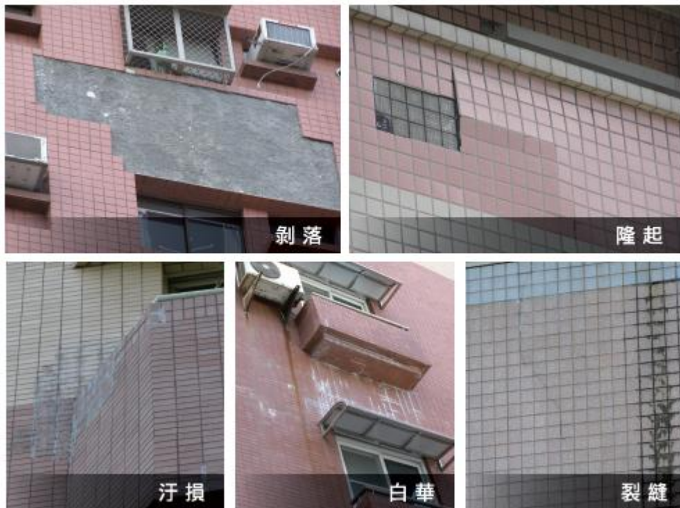
圖 3-1 瓷磚劣化情形
