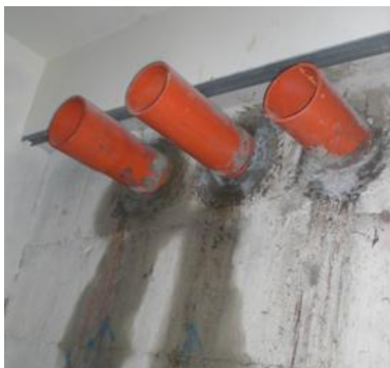
圖 3-90 地下室牆外管貫穿處垂流狀漏水
