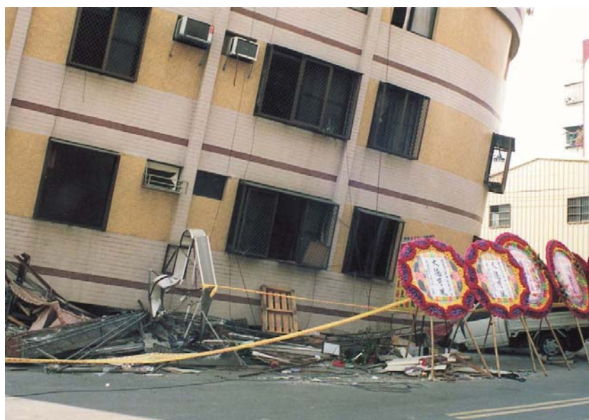
圖 1-1 921 地震大里市騎樓式建築，一樓軟弱層崩塌 (資料來源：本研究)
