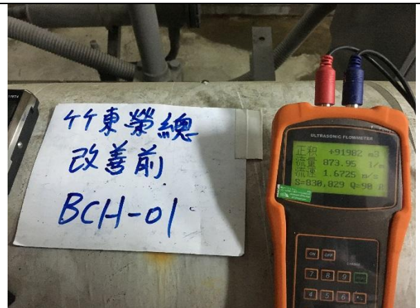
項目：改善前 冰水流量量測
