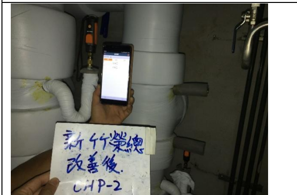
項目：改善後 冰水泵浦壓差量測
