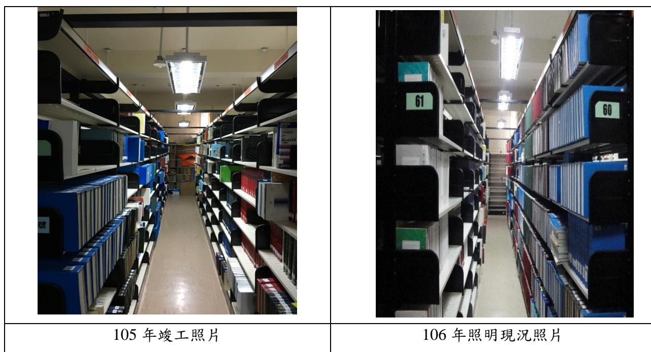
圖 6.15 105 及 106 年度照明改善追蹤照片
