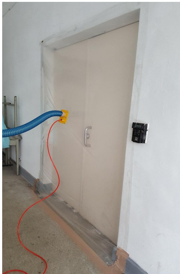
圖 2.7-3 現場遮煙設備操作狀況
