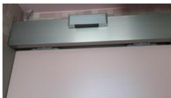
圖 4-116 廁間隔板上部空隙 (本研究整理)
