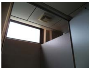
圖 4-28 大便器廁間隔板上部空隙 (本研究整理)
