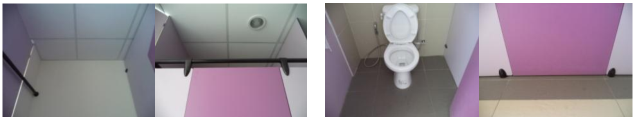
圖 4-154 廁間隔板上、下部空隙(本研究整理)
