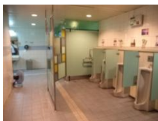
圖 4-80 小便器隔板 (本研究整理)
