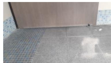
圖 4-126 廁間隔板下部空隙 (本研究整理)
