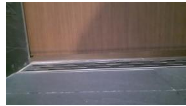
圖 4-92 廁間隔板下部空隙 (本研究整理)
