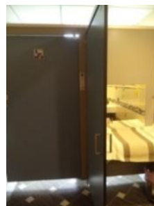
圖 4-66 廁間隔板下部空隙 (本研究整理)
