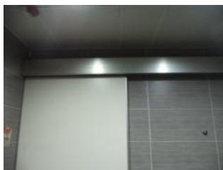
圖 4-96 廁間隔板上部空隙 (本研究整理)
