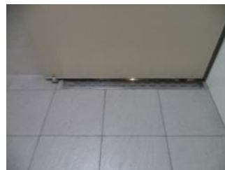
圖 4-112 廁間隔板下部空隙 (本研究整理)
