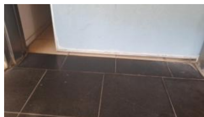
圖 4-135 廁間隔板下部空隙 (本研究整理)
