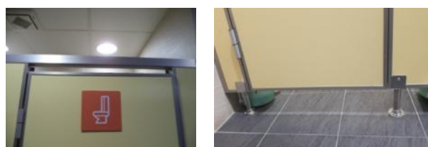
圖 4-121 大便器廁間隔板上、下部空隙 (本研究整理)
