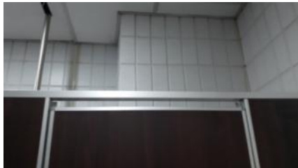
圖 4-44 廁間隔板上部空隙 (本研究整理)
