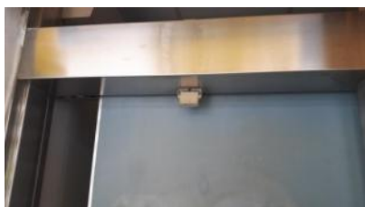
圖 4-134 廁間隔板上部空隙 (本研究整理)
