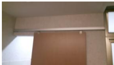
圖 4-91 廁間隔板上部空隙 (本研究整理)
