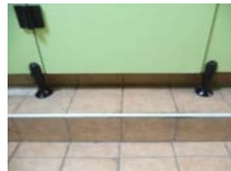
圖 4-40 廁間隔板下部空隙 本研究整理)
