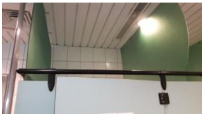
5. 通用無性別廁所大便器隔板上部空隙
