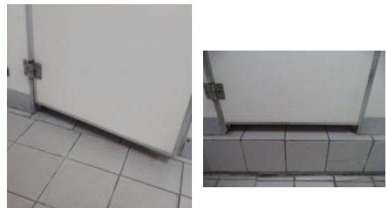
6. 通用無性別廁所大便器門板下部空隙
