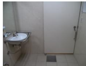
圖 4-107 廁間隔板下部空隙 (本研究整理)
