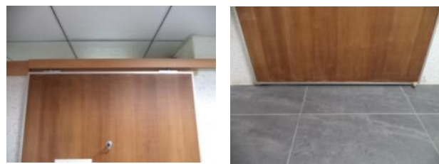
圖 4-130 廁間隔板上、下部空隙 (本研究整理)
