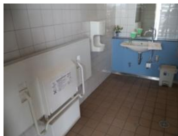
圖 4-162 廁間隔板下部空隙(本研究整理)
