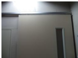
圖 4-111 廁間隔板上部空隙 (本研究整理)
