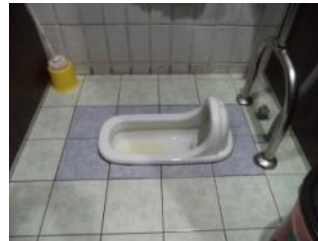
圖 4-45 廁間隔板下部空隙 (本研究整理)
