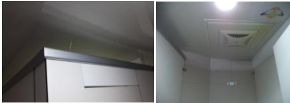
圖 4-54 廁間隔板上部空隙 (本研究整理)
