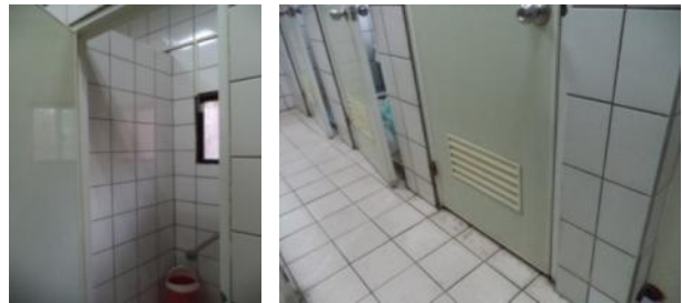
圖 4-3 大便器廁間隔板上、下部空隙 (本研究整理)
