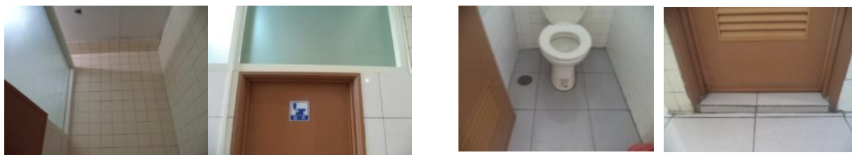
圖 4-144 大便器廁間隔板上、下部空隙(本研究整理)
