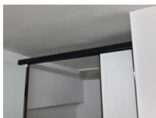
圖 4-33 大便器廁間隔板上部空隙 (本研究整理)
