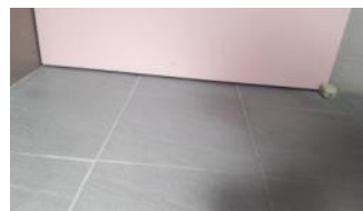
圖 4-117 廁間隔板下部空隙 (本研究整理)
