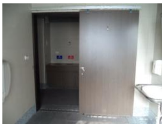
圖 4-125 廁間隔板上部空隙 (本研究整理)
