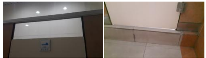
圖 4-139 廁間隔板上、下部空隙 (本研究整理)
