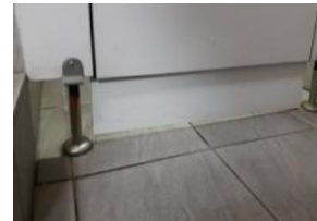
圖 4-55 廁間隔板下部空隙 (本研究整理)
