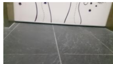
圖 4-97 廁間隔板下部空隙 (本研究整理)
