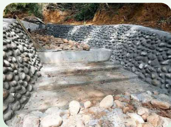
▲ 圖 4-6 機場捷運A7站地區區段徵收公共工程第六標-蝕溝編號8完工照片
