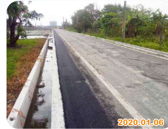
▲ 圖 4-17 宜蘭縣中興(九)早期農地重劃區農水路更新改善後情形
