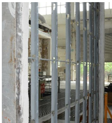
圖 5-23 實驗後立柱彎曲現象
