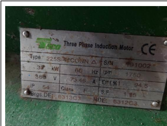
空調設備現況照片-11(CWP-4 37kW)
