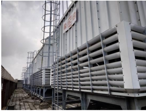
空調設備現況照片-17(冷卻水塔散熱良好)
