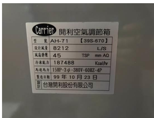
空調設備現況照片-12(7F AHU-71)
