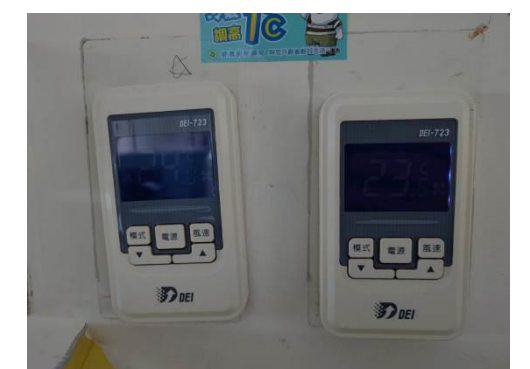
空調設備現況照片-16(FCU 控制器採用自動變速的溫控器)
