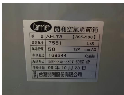
空調設備現況照片-14(7F AHU-73)
