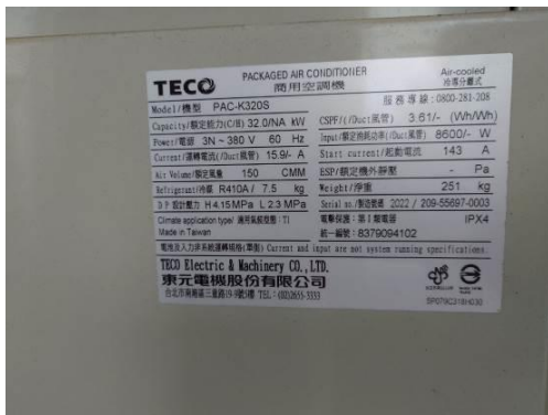
空調設備現況照片-19(11F 餐廳箱型機東元)
