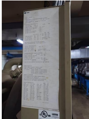
空調設備現況照片-4(既設 420RT 離心式冰 水主機耗電 246kW)
