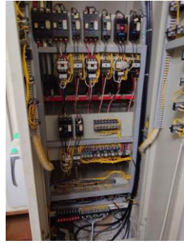
空調設備現況照片-18(控制僅有繼電器控制)
