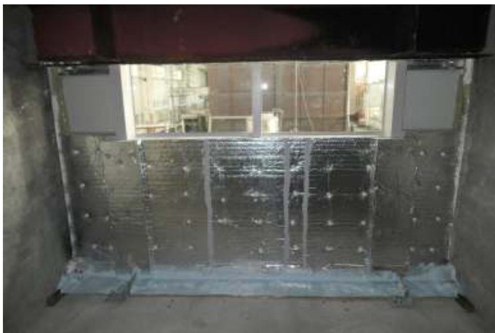
圖 4-10 觀察室外牆內表面使用岩棉進行保護，並在層間塞上方施加 阻煙膠
