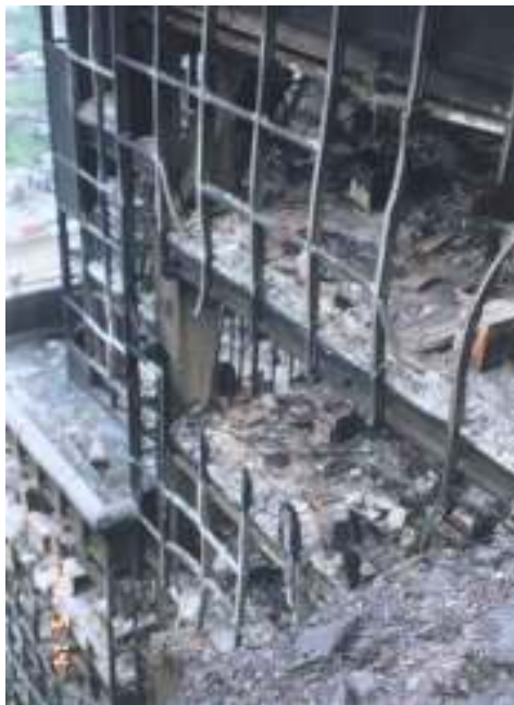
圖 3-14 東方科學園區大樓火災後帷幕牆鋁構架殘景
