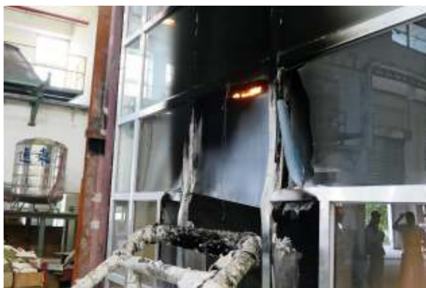
圖 3-55 帷幕牆的鍍鋅鋼板脫落
