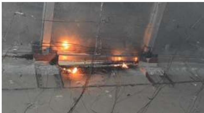
圖 3-53 層間塞非曝火面的阻煙膠引燃現象
