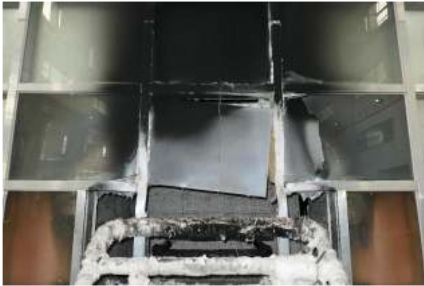
圖 3-56 帷幕牆的鍍鋅鋼板脫落
