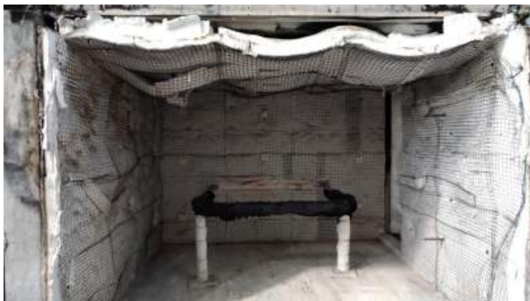
圖 4-31 測試室的天花板鋪棉損壞
