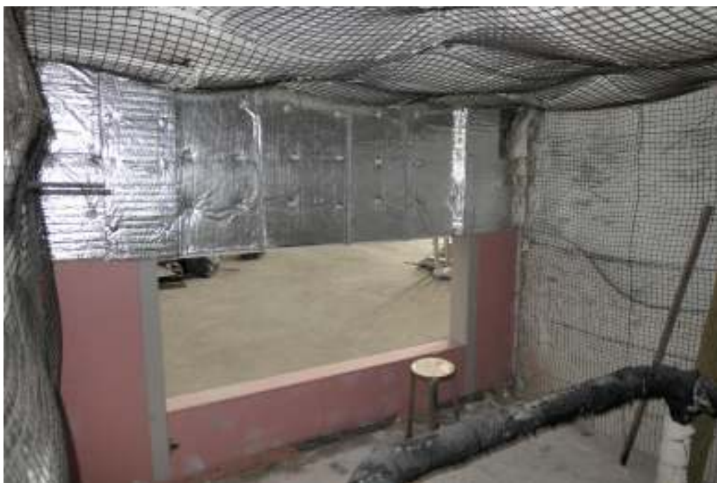
圖 4-9 測試室內部窗戶開口上方使用岩棉進行保護
