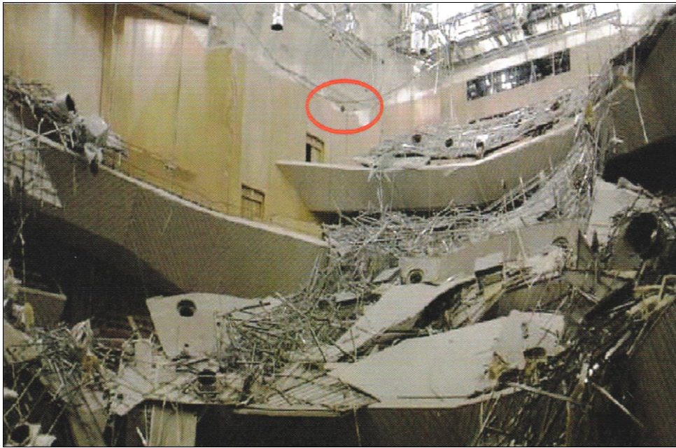
圖 36. 天花板掉落狀況[7]
