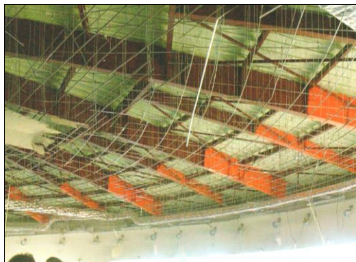
圖 32. 天花板掉落狀況[11]
