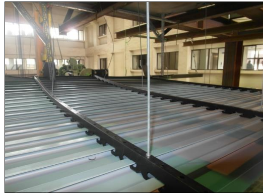
圖 124. T10 支撐架挫屈破壞
