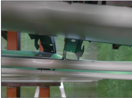
圖 99. T6 支撐架掛勾變形
