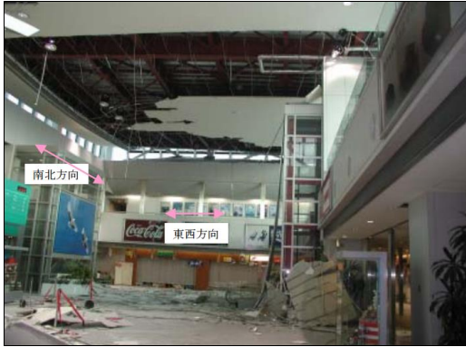
圖 28. 機場天花板掉落情形[10]
