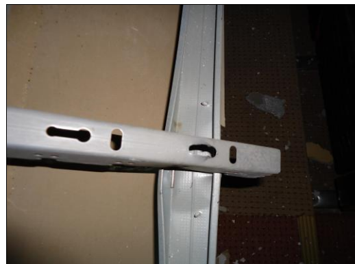
圖 13. 葫蘆孔破壞狀況
