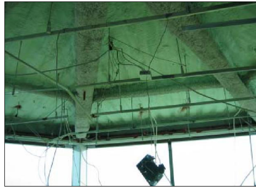
圖 29. 塔台天花板掉落情形[10]
