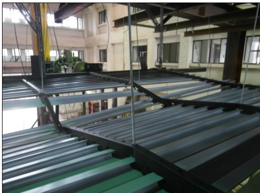
圖 96. T5 支撐架挫屈破壞
