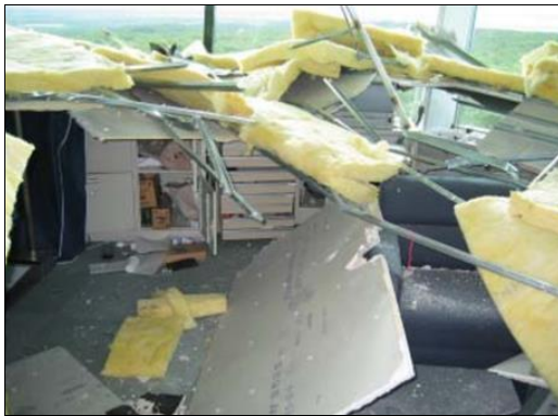
圖 30. 塔台天花板掉落情形[10]
