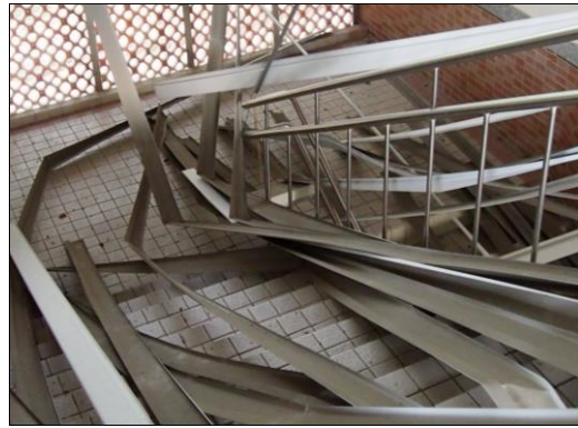
圖 40. 樓梯間天花板掉落狀況
