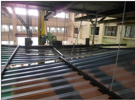
圖 112. T9 支撐架挫屈破壞
