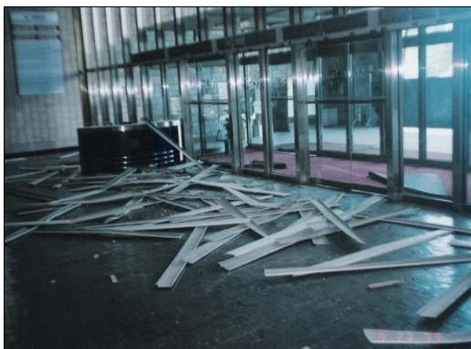
圖 5. 美術館天花板掉落情形
