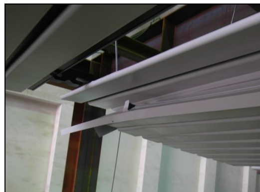
圖 92. T4 支撐架穿破大七字收邊架
