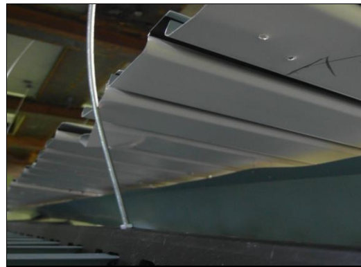
圖 89. T3 吊筋挫屈變形
