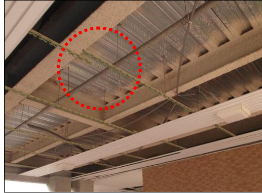
圖 11. 暗架天花板破壞情形
