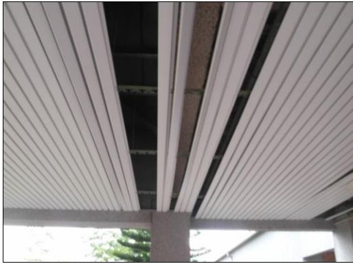
圖 39. 走廊天花板掉落狀況
