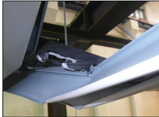
圖 105. T7 支撐架掛勾變形
