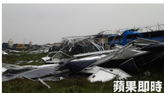
養鴨場屋頂的太陽能板慘遭摧毀。
