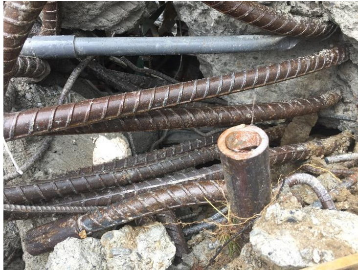
圖 1-1 台南維冠金龍大樓倒塌現場鋼筋續接器失敗案例
