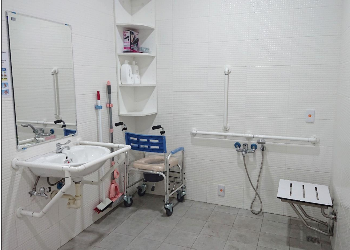
圖 三-15 加裝扶手之浴室、洗澡椅及槓桿式水龍頭 (資料來源：本研究團隊拍攝)
