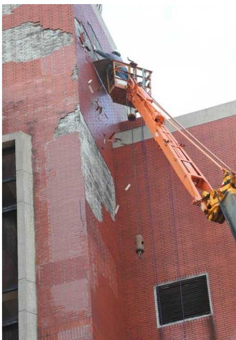
圖 1-2 瓷磚剝落劣化案例 2
