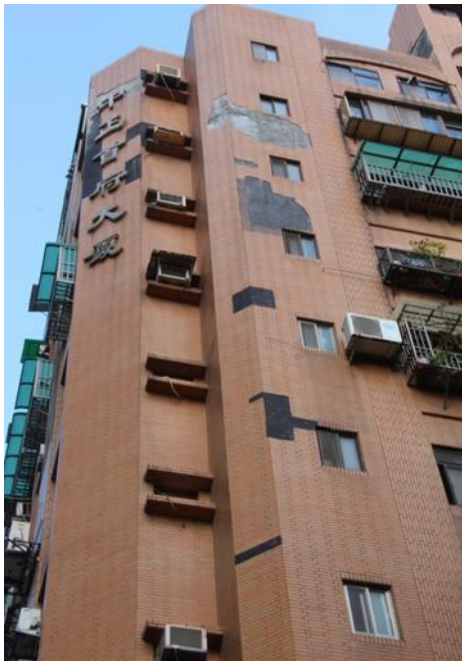
圖 1-1 瓷磚剝落劣化案例 1
