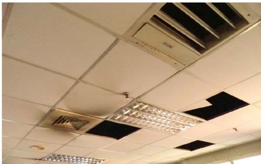
圖 1.6 護理站前走廊上方天花板送風口有煙滲漏情形 (本圖取自參考文獻[6])
