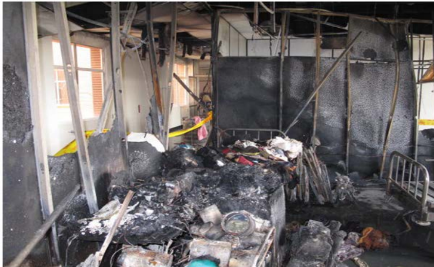
圖 1.5 產房內部燒毀情景(靠天井走廊側) (本圖取自參考文獻[6])
