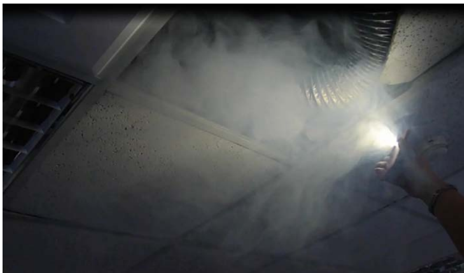
圖 5.26 煙塵經由天花板上方空間水平擴散到隔壁倉庫
