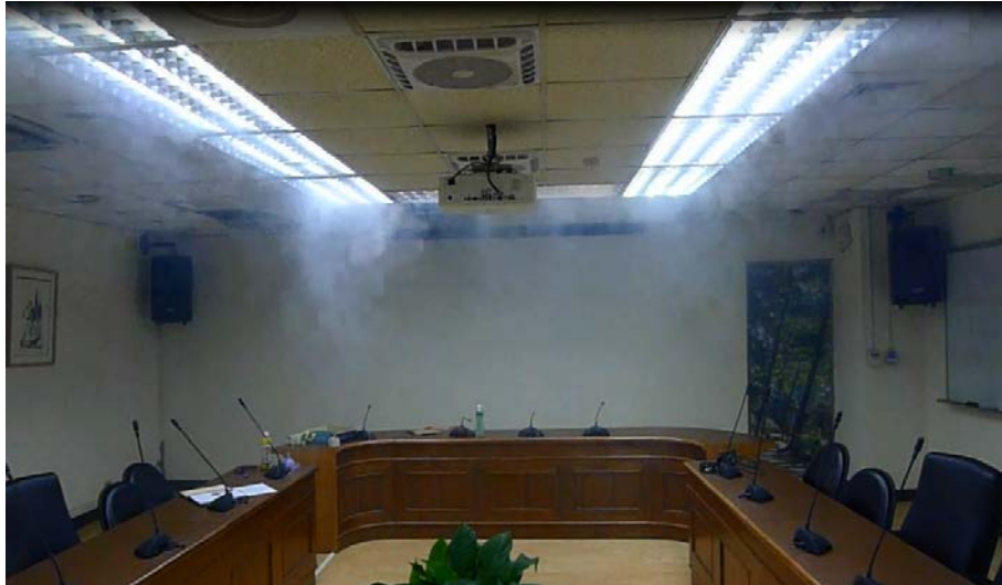
圖 5.32 煙塵經由空調風管輸送到各個送風口造成煙塵擴散
