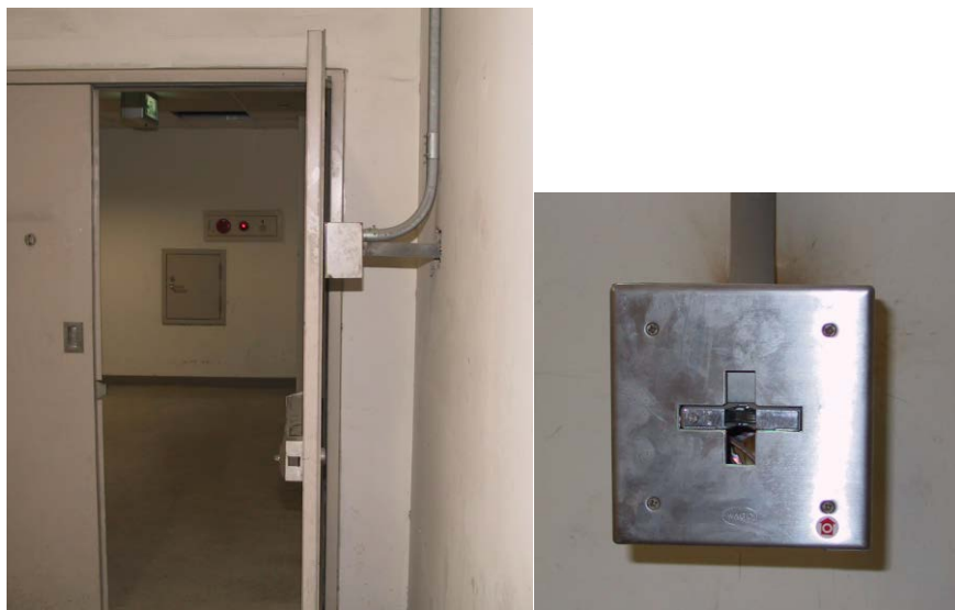
圖 6.4 安全門自動關閉之設置
