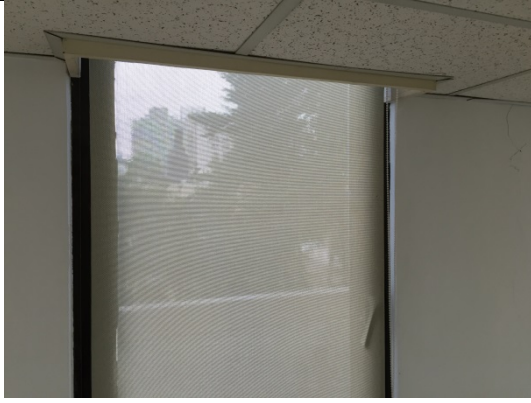
排煙風管路徑與既有窗簾裝潢衝突
