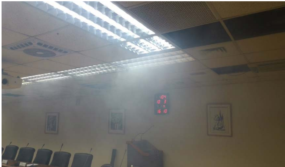
圖 5.33 煙塵經由空調風管輸送到各個送風口造成煙塵擴散
