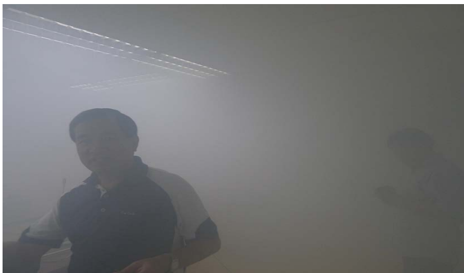
圖 5.34 煙塵經由空調風管輸送到各個送風口造成煙塵擴散
