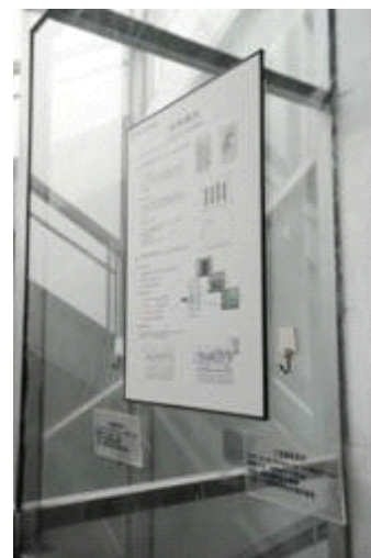
圖 4-63 節能研究中心浮力通風換氣井進氣口
