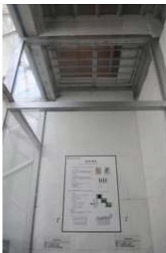
圖 4-62 節能研究中心浮力通風換氣井上部
