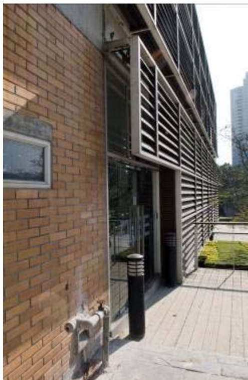
圖 4-52 西向立面外遮陽設施
