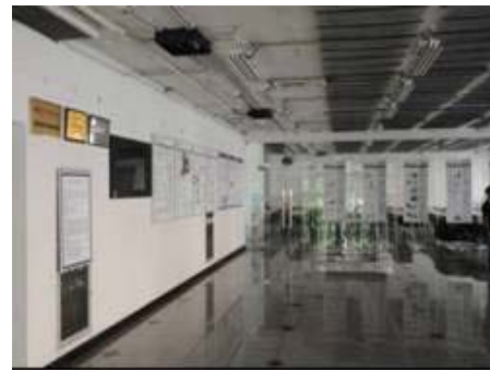
圖 4-59 節能研究中心天花板面輻射空調
