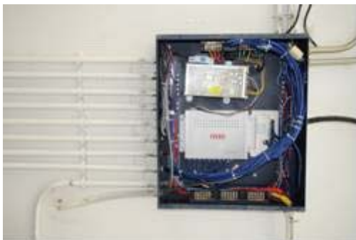
圖 4-60 節能研究中心天花板面輻射空調控制器
