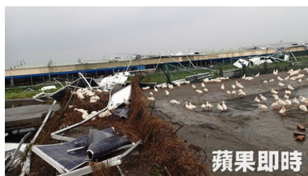
太陽能板飛到另處養鴨場水池。
