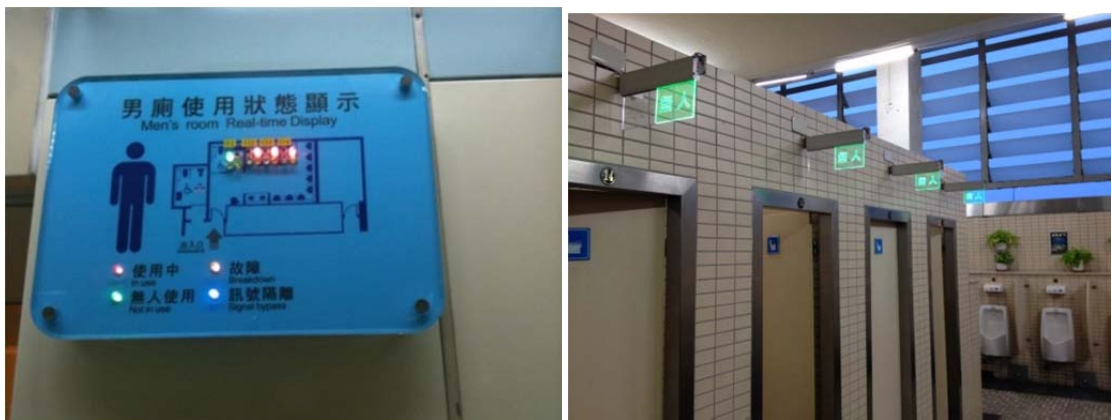
圖4-22設置廁內外設置使用狀態顯示裝置
