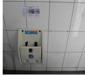
圖3-64無障礙廁所多項設施應重新設置並加強清潔度
