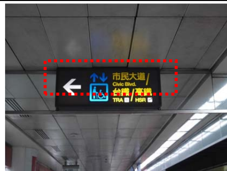
圖3-11指示牌上方燈管壞掉，影響閱讀性
