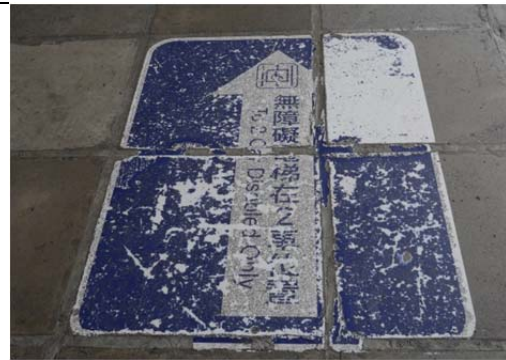
圖3-55貼地式指標嚴重破損
