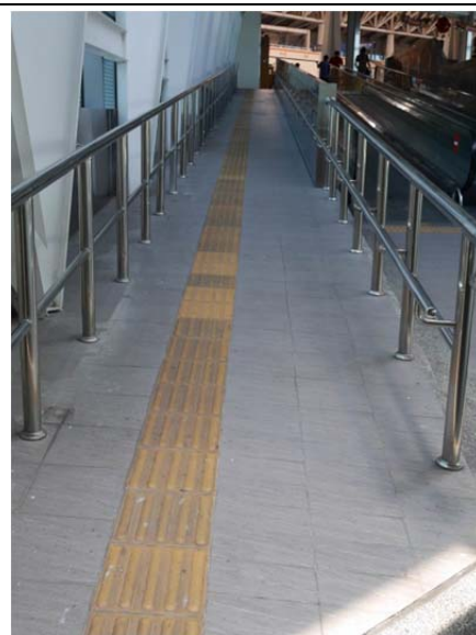
圖3-35 斜坡道上不應鋪設導盲磚
