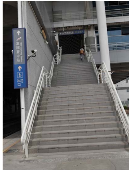
圖3-39 皆為新烏日車站階梯，維護管理、警示裝置設置不同
