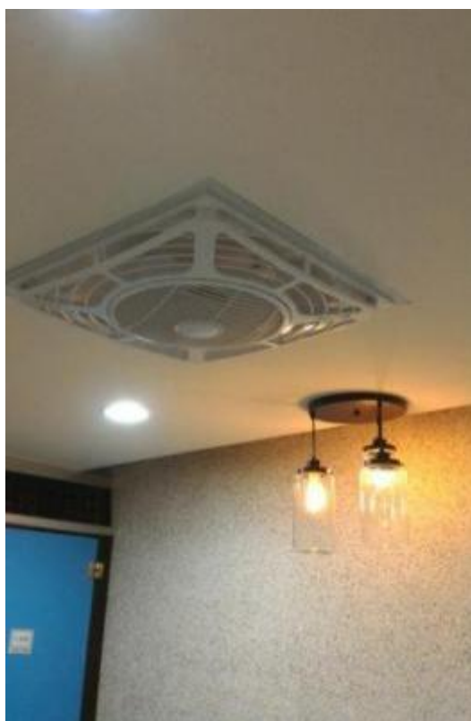
廁所內採機械換氣，減少廁所臭味。
