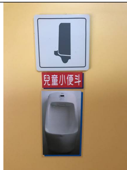
12. 小便斗門板標誌(提供便器照片)
