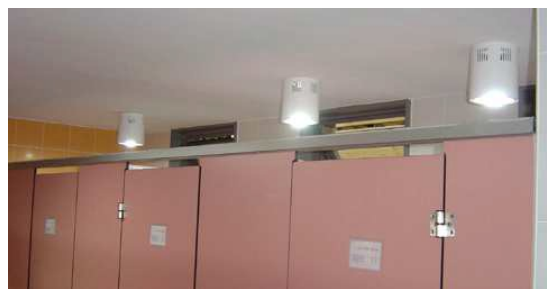
圖 3-12 廁間之照明裝置
