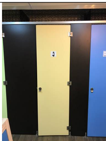
8. 小便斗門板標誌
