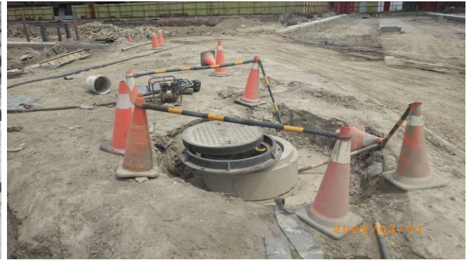
▶▶ 污水人孔蓋因試水未蓋妥，周圍安全警示設施未完整設置
