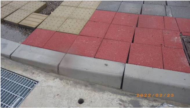
▶▶ 路口轉彎緣石及人行道鋪面磚縫隙過大
