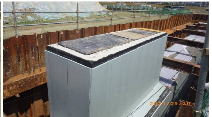
▶▶ X15 路共同管道材料投入口預留鋼筋未設置或長度不足
