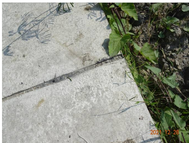
▶▶ 道路側溝伸縮縫填縫膠施作不良，有脫落及凹陷情形
