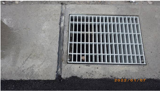
▶▶ 道路側溝保麗龍伸縮縫(含填縫膠)下陷未與側溝頂施作齊平
