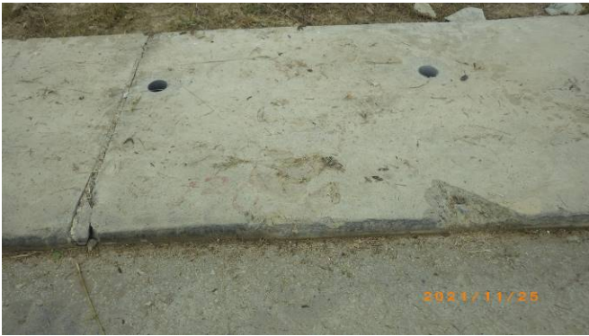
▶▶ 混凝土側溝頂版伸縮縫處未施作填縫膠，且有壓損情形
