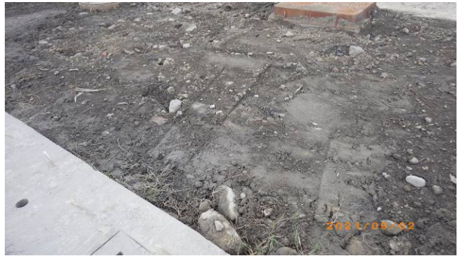
▶▶ 路床含有較大之礫石未清除
