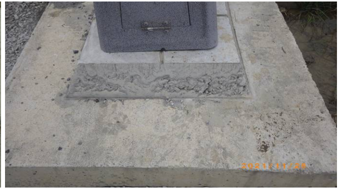
▶▶ 路燈及號誌混凝土基礎座多處有蜂窩、氣泡現象
