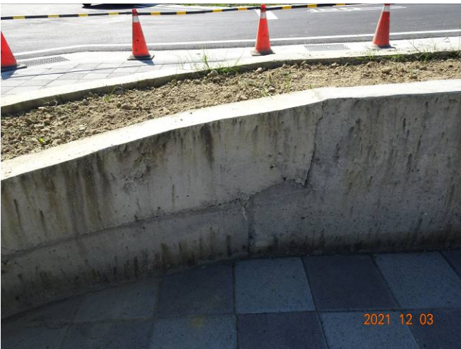
▶▶ 公園花台混凝土分次澆置，產生施工冷縫及裂縫
