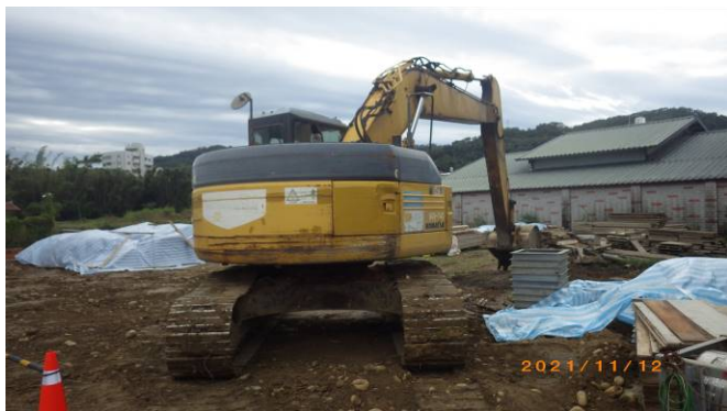
▶▶ 施工機具(挖土機)未裝設旋轉警示燈及蜂鳴器
