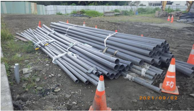
▶▶ 管材堆置未墊高保護
