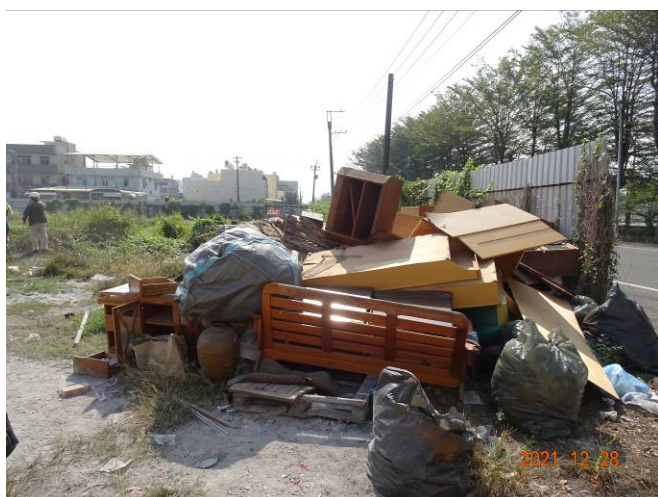
▶▶ 工地內廢棄物未依契約規定運棄
