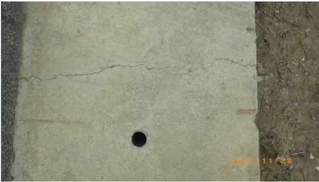
▶▶ 道路側溝頂版混凝土完成面有塑性收縮裂縫
