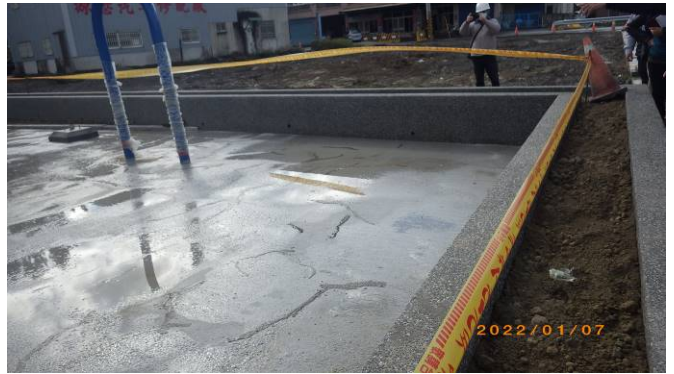
▶▶ 兒童公園打底混凝土路面有嚴重積水情形及未有高程規劃控制作為
