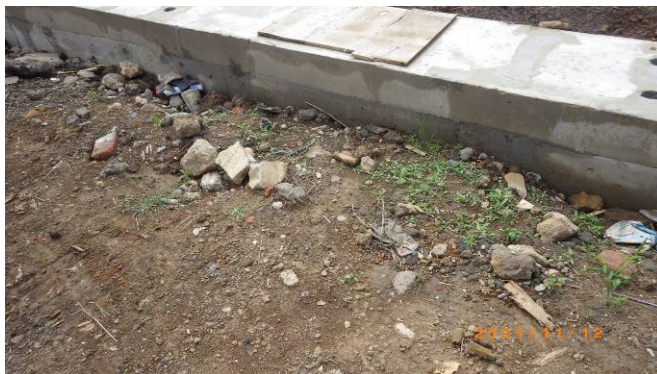
▶▶ 計畫道路回填土有雜物(瀝青混凝土塊、大石、紅磚塊及鋼筋等)未清除
