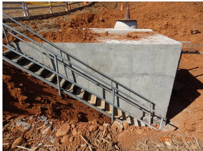
▶▶ 箱涵混凝土牆身有冷縫
