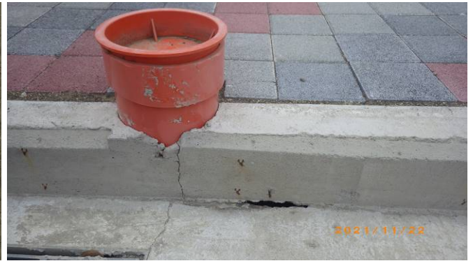
▶▶ 污水工程家戶接管之清掃孔突出於人行道，影響行人安全
