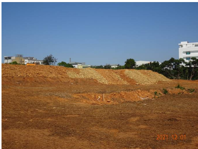
▶▶ 部分裸露地表及土方堆置區未鋪設防塵網
