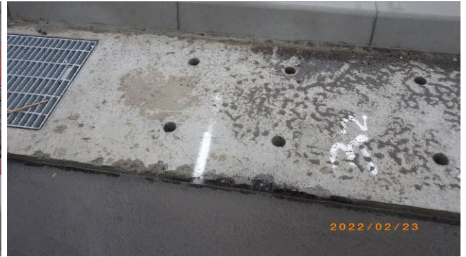
▶▶ 道路側溝頂版邊緣有多處破損情形
