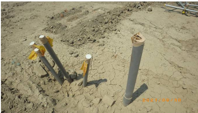
▶▶ 道路路燈電線預留管開口處未確實封口保護
