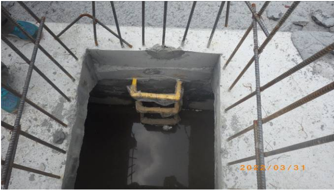
▶▶ 雨水箱涵開口預留筋保護層厚度不足
