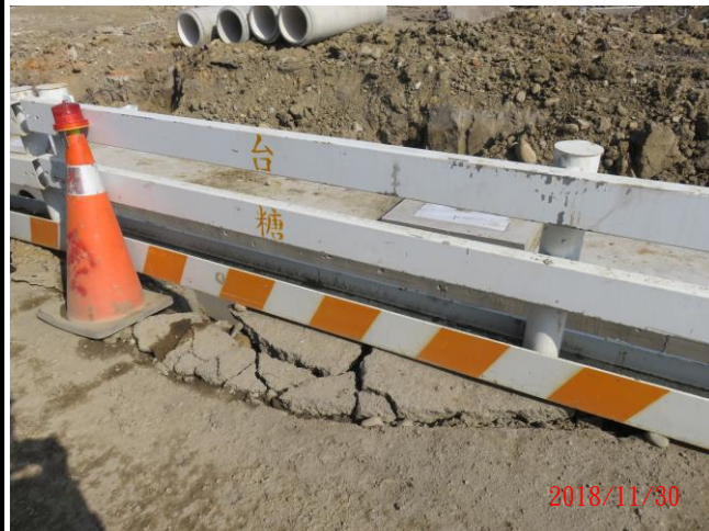
安全護欄未符規定
