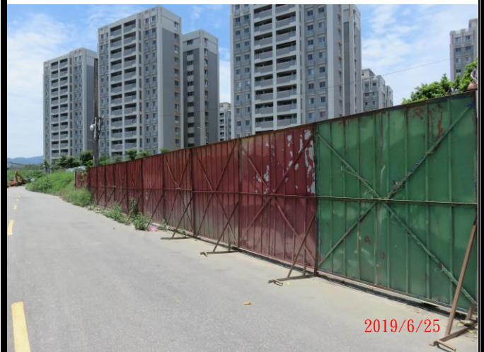
屈原宮附近之圍籬，未設置夜間警示燈
