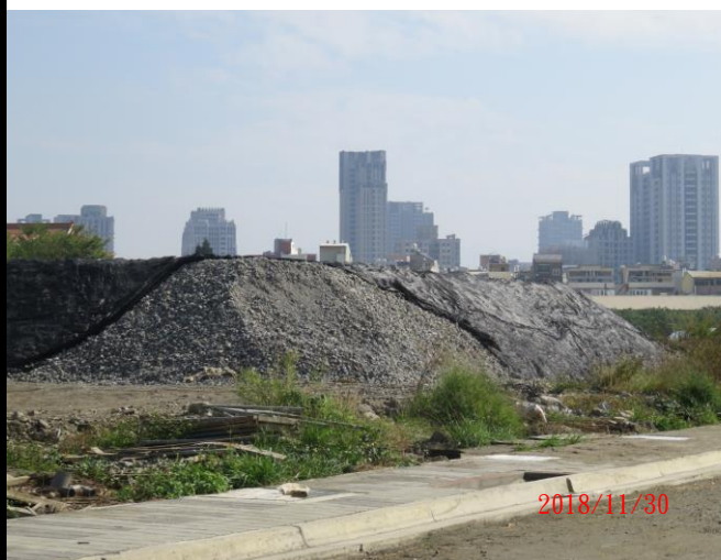
堆置土方防塵網覆蓋不全
