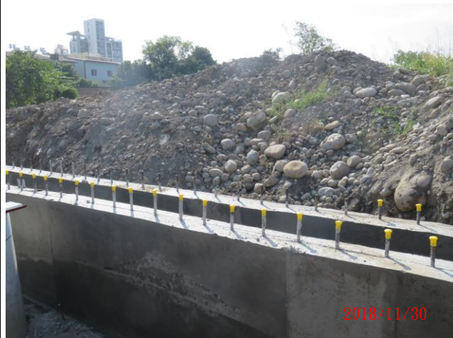
部分預留鋼筋未設置保護套
