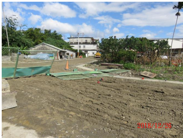
1 號滯洪池周邊活動式圍籬未適當加固
