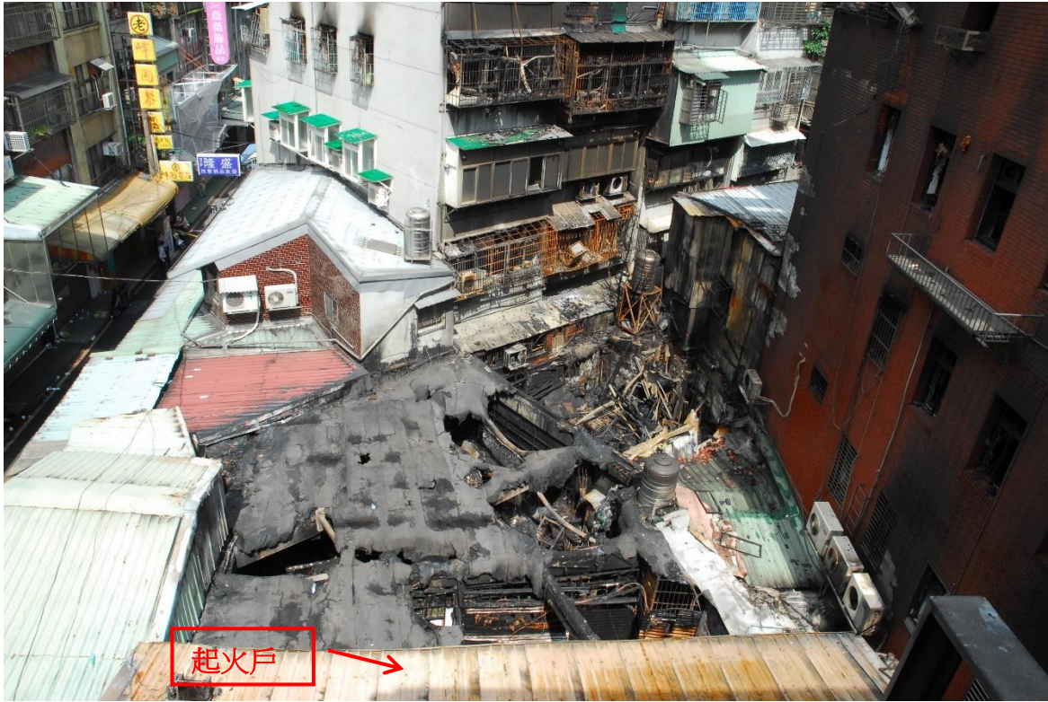
圖 2-27 延燒全景火場照片 10
