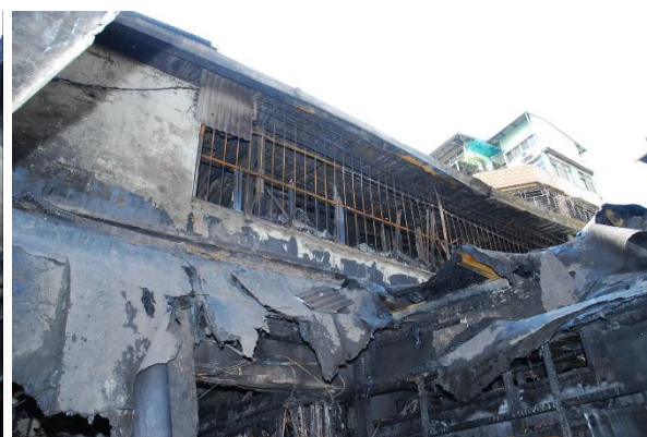
f.起火戶屋頂燒破後，往 2F 勘查
