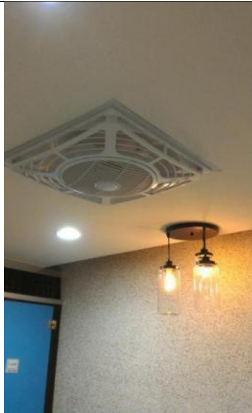
圖 13-5 廁所內採機械換氣，減少廁所臭味。(來源：內政部建築研究所，104)
