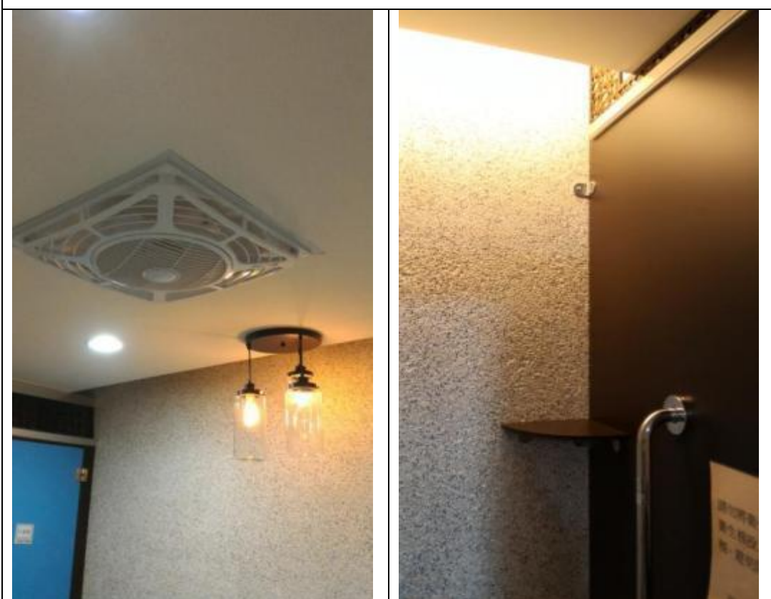
圖 13-5 廁所內採機械換氣，減少廁所臭味。(來源：內政部建築研究所，2015)
