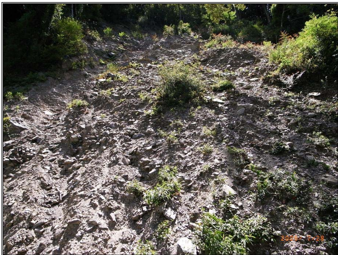
照片 4-1-7 大鹿林道東線道路邊坡崩塌情形之三( 攝於 2009 年 8 月 )
