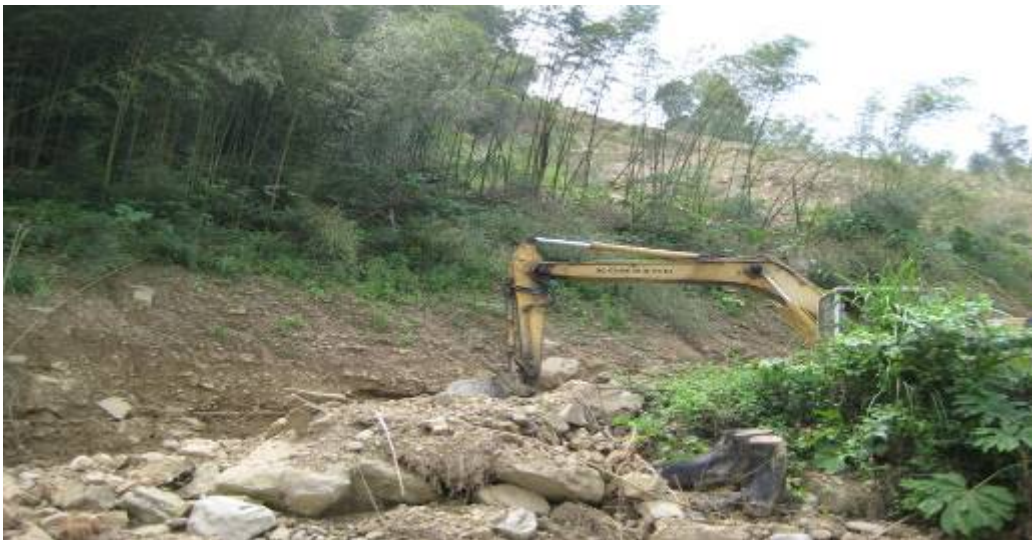
照片 3-2 道路邊坡崩塌情形( 攝於 2009 年 9 月 )
