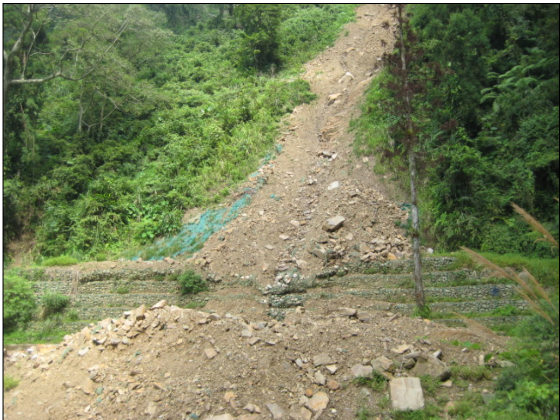
照片 4-1-3 司馬限林道道路崩塌情形( 攝於 2009 年 7 月 )
