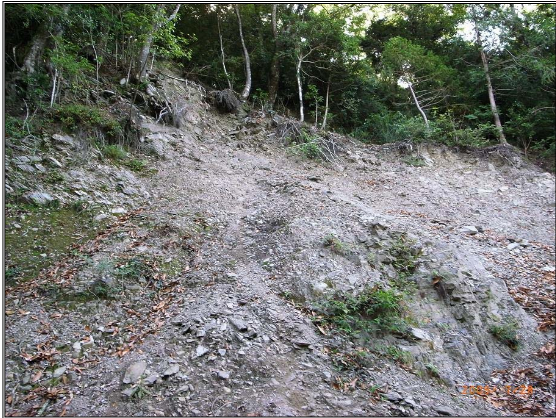
照片 4-1-5 大鹿林道東線道路邊坡崩塌情形之一( 攝於 2009 年 8 月 )
