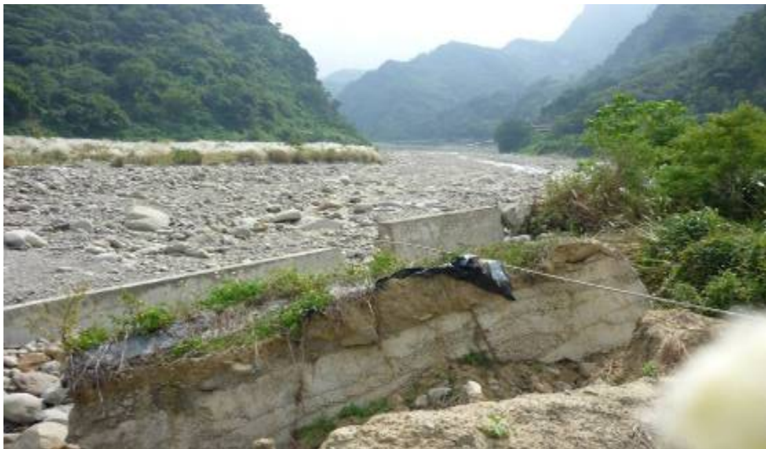
照片 4-1 雪霸國家公園管理處上游堤防嚴重毀損情形( 攝於 2009 年 9 月)
