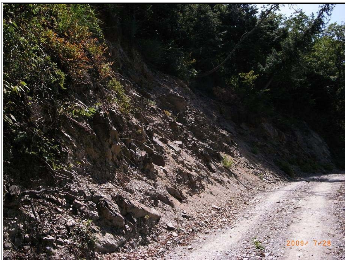
照片 4-1-6 大鹿林道東線道路邊坡崩情形之二( 攝於 2009 年 8 月 )
