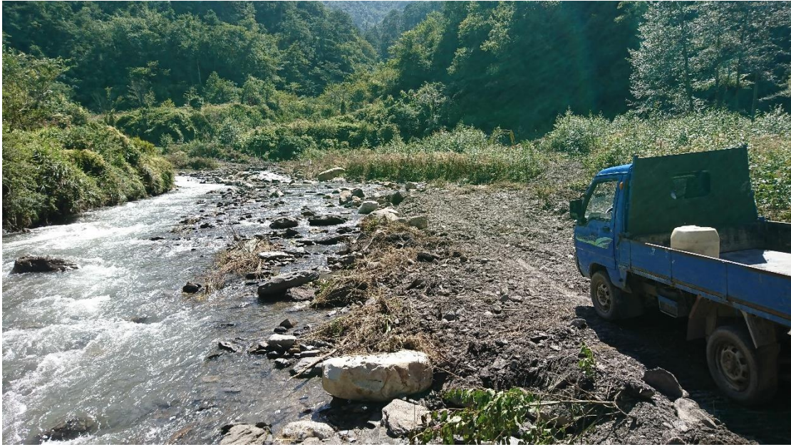
圖 8-29、2019 年 8 月颱風過後，有勝溪蘭花橋一帶的臨溪農路施工，導致下游溪水混濁，相同情況 10 月再度發生。(洪孝宇拍攝)
