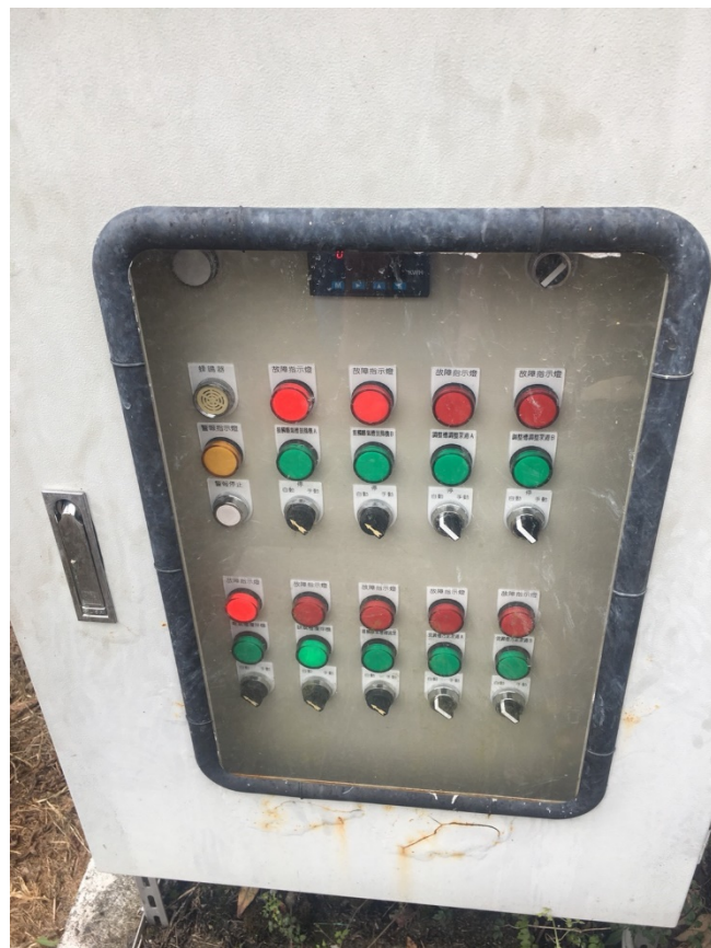
圖 4-80 武陵農場露營區污水處理設備(除此面板外並無處理設備設於地面)
