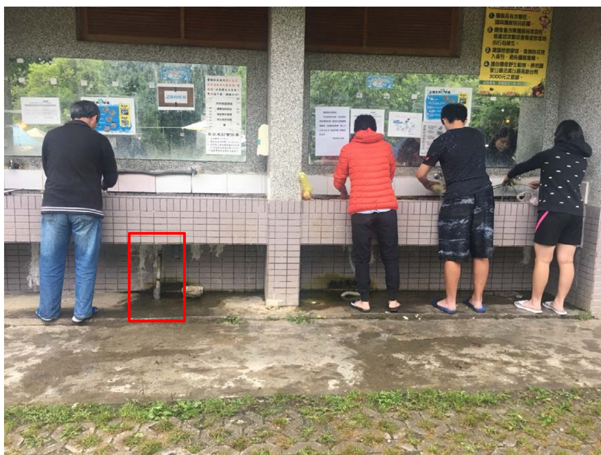
圖 4-78 武陵農場露營區提供之洗手台管線配置(接管直接埋入地下) (資料來源：本研究資料)
