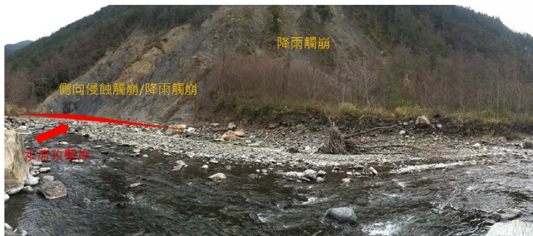
圖 5-25 二號壩上游 415 m 處邊坡側向侵蝕現地照片
